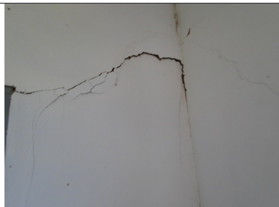
Figura 12 – detalhe de trinca em um dos encontros das alvenarias
