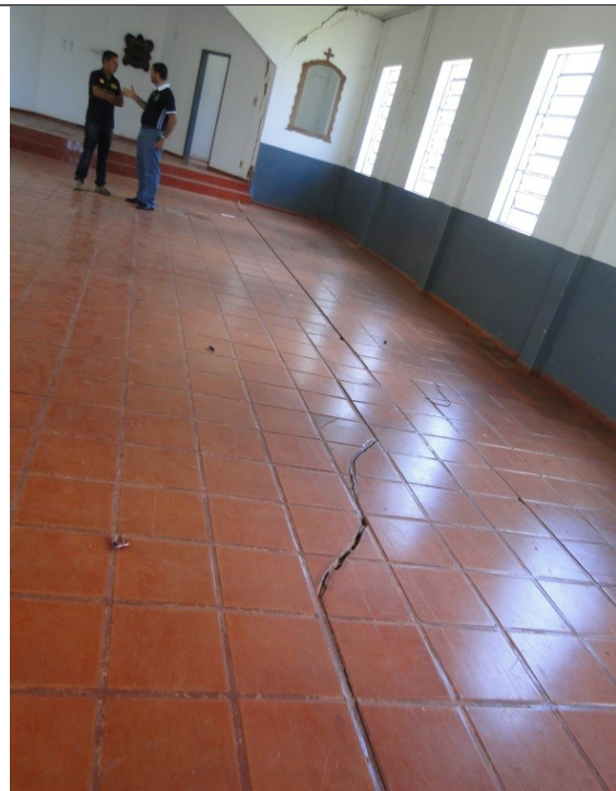
Figura 10 – detalhe da trinca no piso
