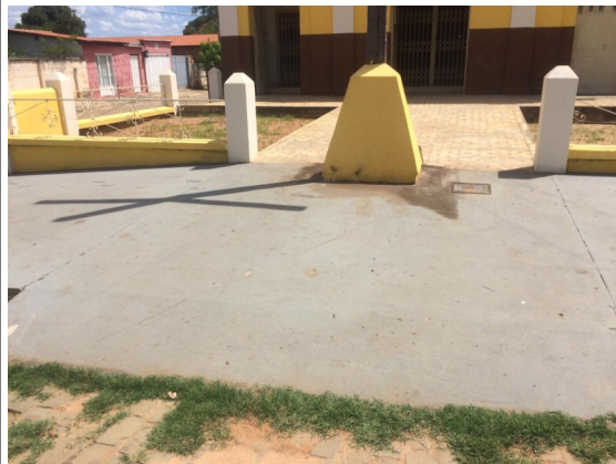
Figura 05 - Rampa junto ao meio fio.
