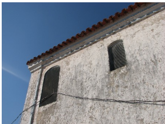
FIGURA 38 –Detalhe manchas de infiltração e ligações elétricas executadas de maneira improvisada.
