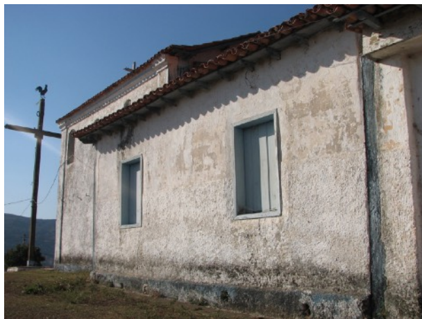
FIGURA 35–Fachada lateral esquerda. Sujidades na pintura, manchas de infiltração.
