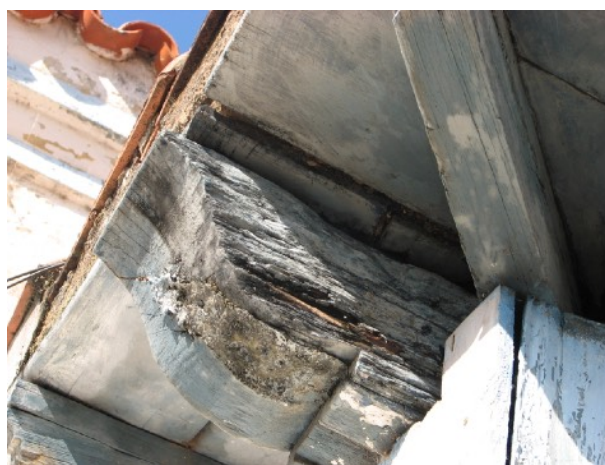
FIGURA 43 - Madeiramento em ruim estado de conservação.
