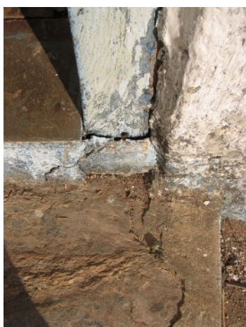
FIGURA 42 –Detalhe madeiramento desprendendo da alvenaria.
