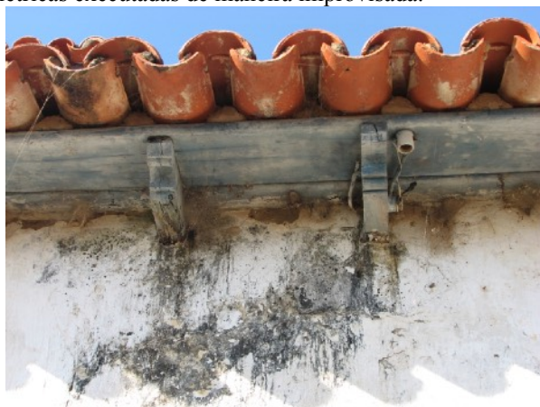
FIGURA 41– Detalhe manchas de infiltração e ligações elétricas executadas de maneira improvisada.
