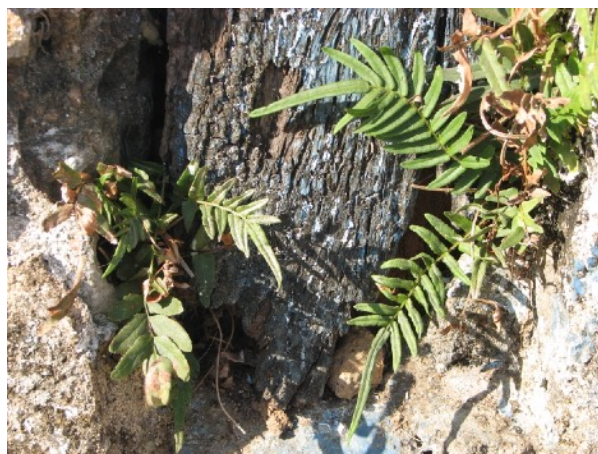
FIGURA 37 –Detalhe manchas de infiltração, estado ruim do madeiramento e presença de plantas invasoras.
