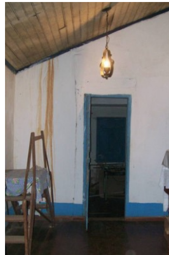
FIGURA 55- Área interna: manchas de infiltração, sujidades nas paredes, madeiramento em estado ruim de conservação.
