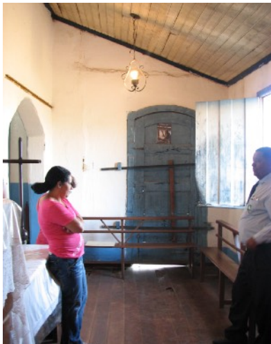
FIGURA 54- Área interna: manchas de infiltração, sujidades nas paredes, madeiramento em estado ruim de conservação.
