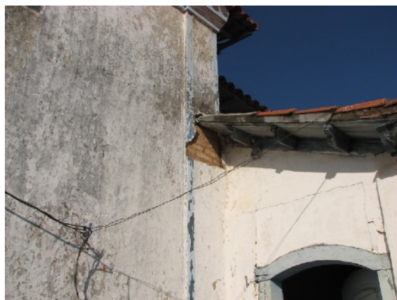
FIGURA 39 - Detalhe manchas de infiltração e ligações elétricas executadas de maneira improvisada.
