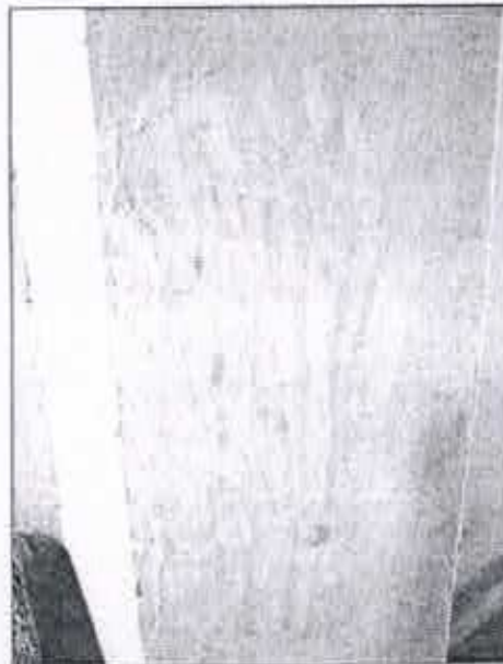
Fig 07: Manchas na pintura interna. Capela N. Sra. Bom Despacho, Sabará, fev. 2008
