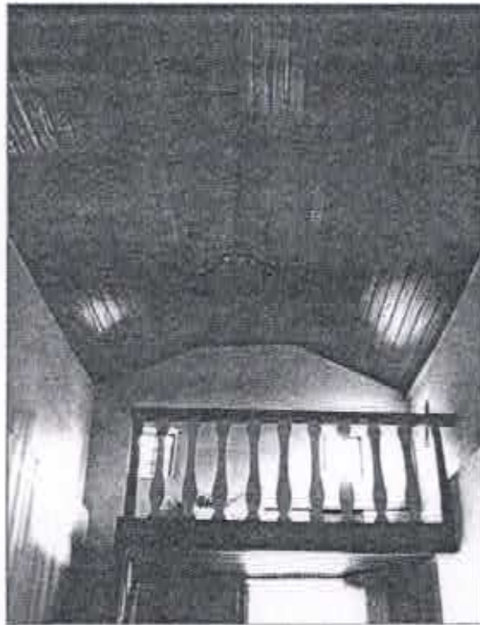
Fig. 14: Forro de madeira em bom estado de conservação Capela N. Sra. Bom Despacho, Sabará, fev. 2008
