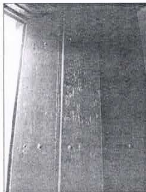
Fig. 10: Folha de madeira da fachada frontal com leve desgaste na pintura. Capela N. Sra. Bom Despacho, Sabará, fev. 2008
