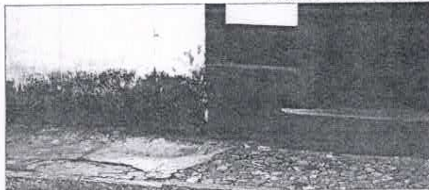
Fig 08: Manchas de umidade no embasamento externo da edificação. Capela N. Sra. Bom Despacho, Sabará, fev. 2008
