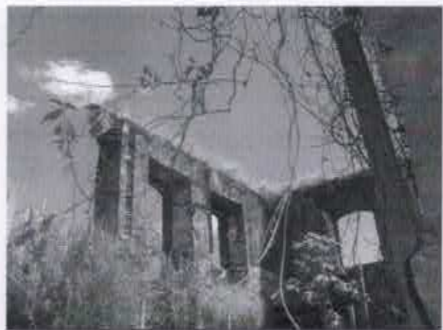
Imagem 36 - Vegetação crescente nas paredes remanescentes da edificação
