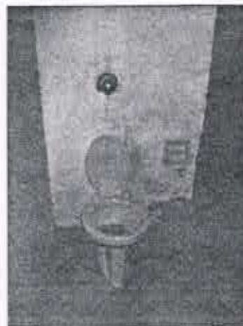
Fig. 33: Vazamento na instalação sanitária. Teatro Municipal, Sabará, fev. 2008.
