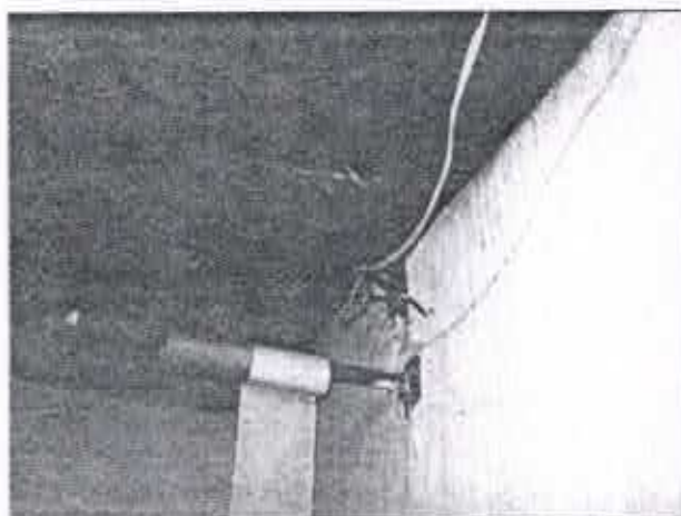
Fig. 32: Fiação elétrica aparente da instalação sanitária. Teatro Municipal, Sabará, fev. 2008.
