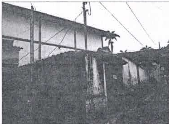
Fig. 26: Muro externo de divisa posterior. Teatro Municipal, Sabará, fev. 2006
