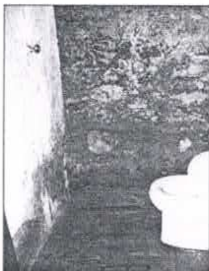
Fig. 09: Detalhe da infiltração na parede do banheiro. Teatro Municipal, Sabará, fev. 2008.
