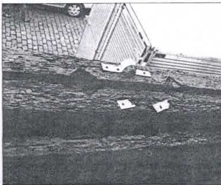
Fig. 16: Enquadramento deteriorado da janela frontal. Teatro Municipal, Sabará, fev. 2008
