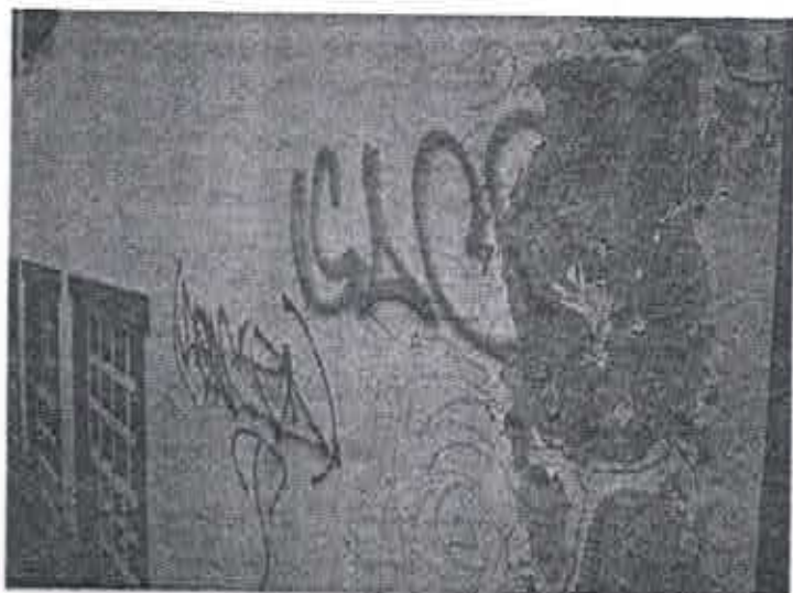
Fig. 20 : Vandalismo na fachada de casa da Rua Princesa Isabel. Conjunto da Praça Bueno Brandão, Sabará, jan.2008
