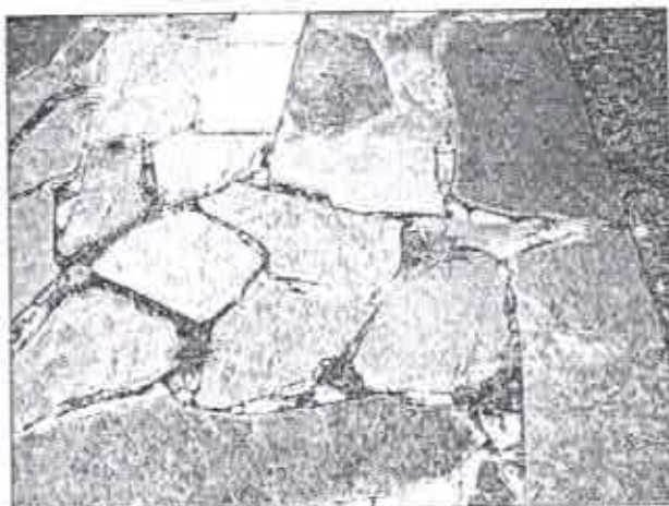
Fig. 22: Destaque para vegetação crescente entre as pedras do caminho central. Capela Nossa Senhora do Rosário, Ravena, mar. 2008
