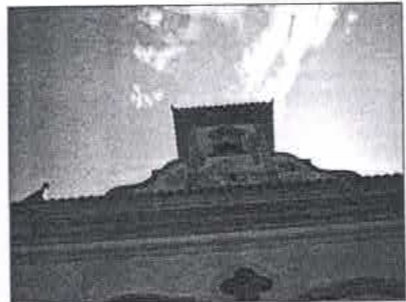
Fig. 12: Manchas e pintura desgastada no frontão. Igreja Nsa. Sra. da Assunção da Lapa, Ravena, mar. 2008
