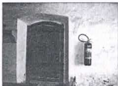
Fig. 55, 56 e 57: Extintores de incêndio sem sinalização adequada e alguns encostados ao chão. Igreja Nossa Senhora da Assunção da Lapa, Ravena, mar. 2008.
