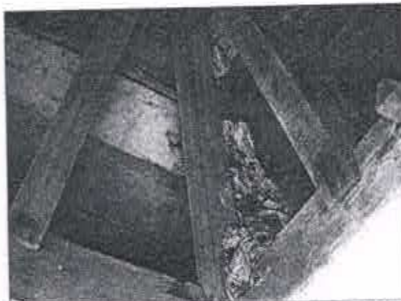
Fig. 06: Vista do engradamento da torre sineira. Destaque para a colônia de cupins encontrada. Capela Nossa Senhora do Rosário, Ravena, mar.2008
