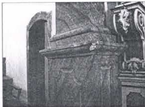
Fig. 47: Perda na quina da pilastra de do arco-cruzeiro. Ig. Nsa. Sra. da Assunção da Lapa, Ravena, mar. 2008
