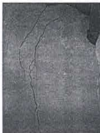
Fig.02: Trinca localizada próxima à escada de acesso à torre. Ig. Nsa. Sra. da Assunção da Lapa, Ravena, mar. 2008
