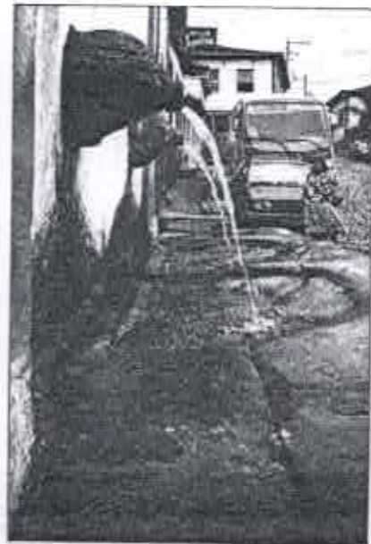
Fig. 08: Manchas de umidade próximas às bicas. Chafariz do Kaquende, Sabará, jan. 2008
