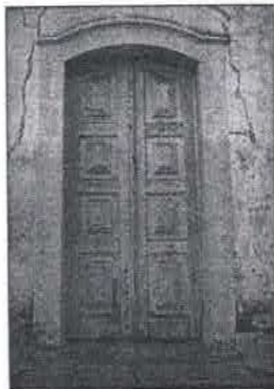
Fig. 21: Vista externa da porta demonstrando desgaste na pintura e porção inferior degradada. Ig. Nsa. Sra. da Assunção da Lapa, Ravena, mar. 2008
