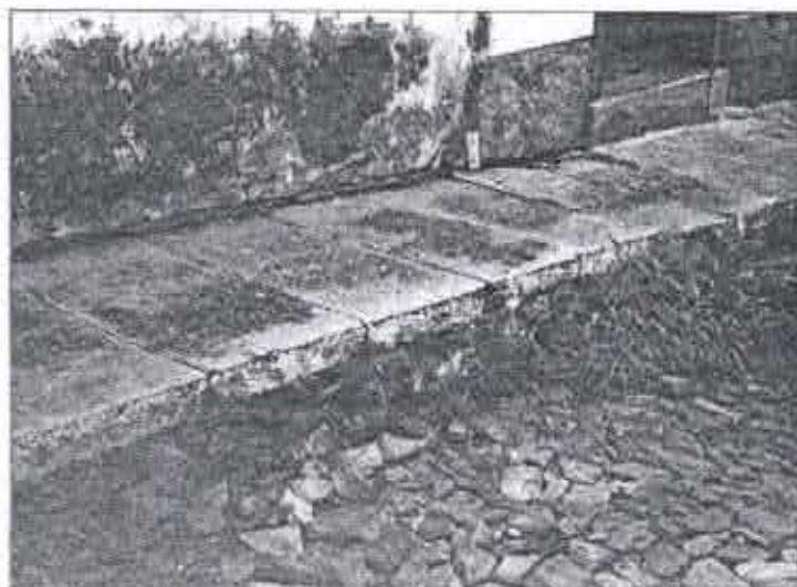
Fig. 01: Vegetação rasteira cresce na via pavimentada. Conjunto Rua Abreu Guimarães, Sabará, jan.2008
