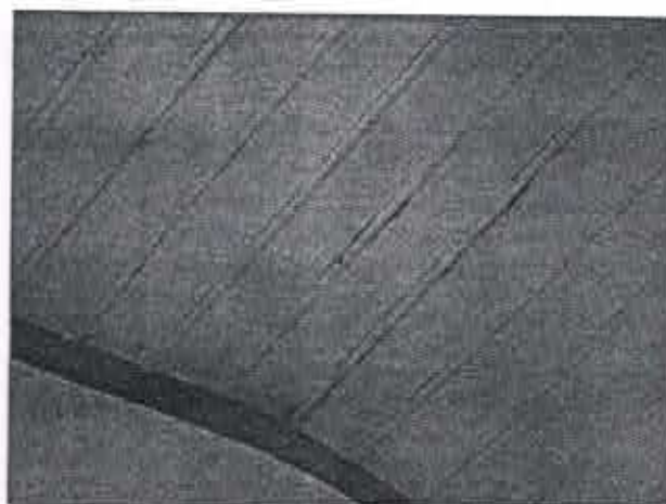
Fig. 20: Detalhe do forro com sinais de infiltração e perda da calafetação. Capela Nossa Senhora do Rosário, Ravena, mar 2008
