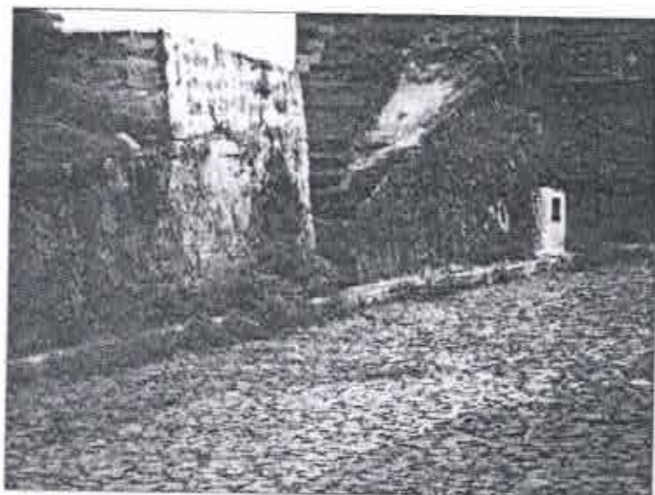
Fig. 04: Vegetação dificulta a drenagem superficial.
