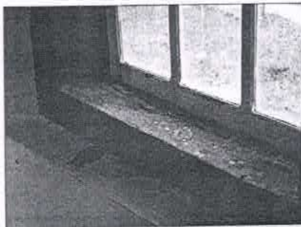
Fig. 15: Detalhe do enquadramento da janela apresentando madeira ressecada e desgastada. Capela Nossa Senhora do Rosário, Ravena, mar. 2008
