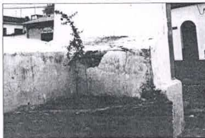
Fig 06: Reboco parcialmente destruído. Chafariz do Kaquende, Sabará, jan. 2008
