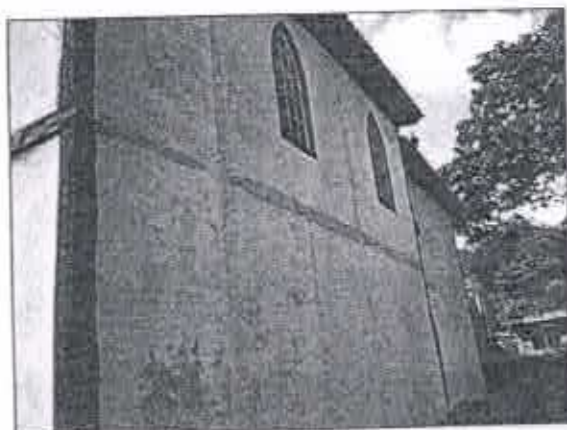
Fig. 10: Vista externa da capela. Destaque para a caiação desgastada. Capela Nossa Senhora do Rosário, Ravena, mar.2008
