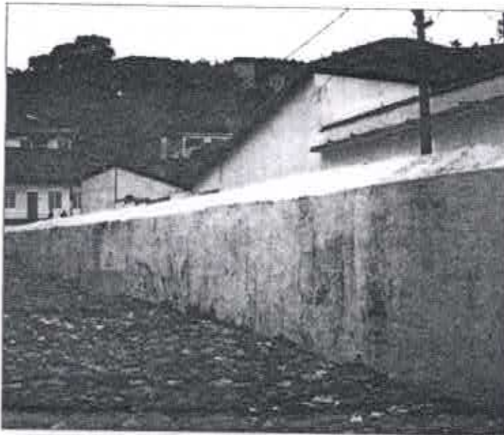
Fig. 07: Pintura manchada na parte posterior do chafariz. Chafariz do Kaquende, Sabará, jan. 2008
