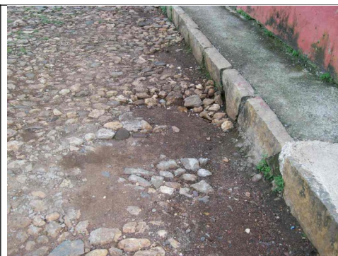
Figura 17 – Lacunas, acúmulo de terra e pedras soltas.
