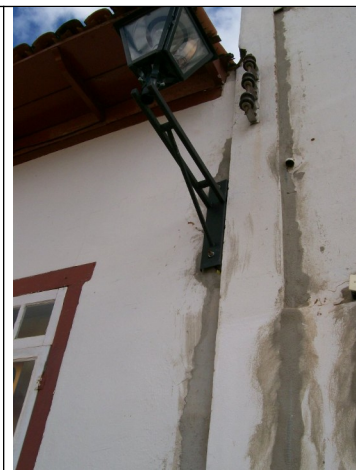
Figura 06 – Falta de pintura nas fachadas dos imóveis.
