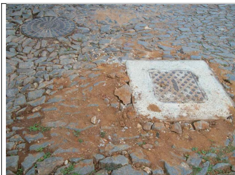
Figura 16 - Pedras soltas, acúmulo de terra e desnivelamentos.
