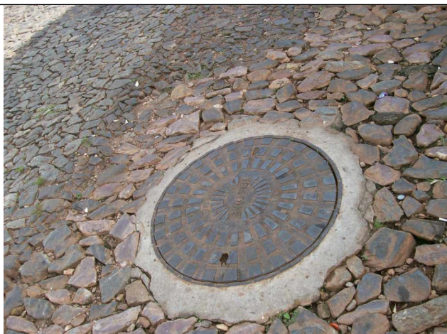
Figura 05 – Pedras do trecho reassentado com tonalidade e assentamento diferente do trecho original.
