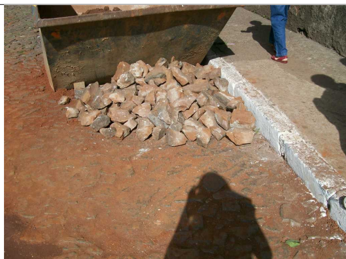
Figura 08 – Pedras soltas na via, sem a devida proteção.
