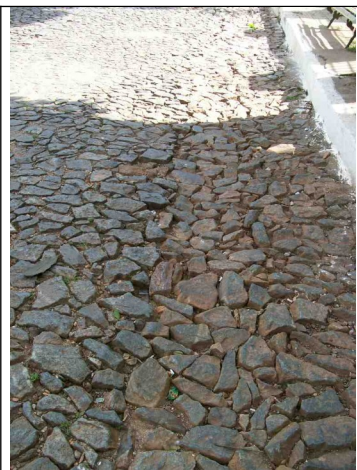
Figura 04 – Desnívelamento da pista e falta de rejunte entre as pedras.
