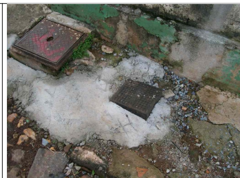
Figura 18 – Desnívelamento entre as caixas e acabamento mau executado.
