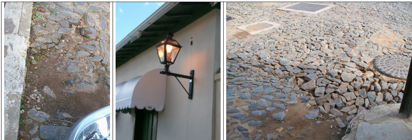
Figura 19 – Lacunas e acúmulo de terra.
