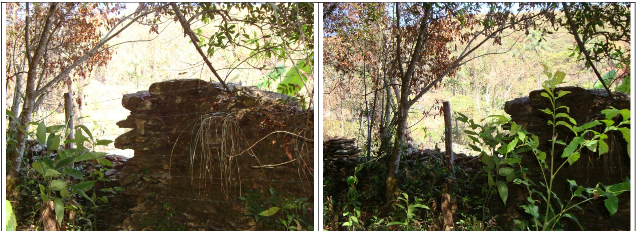
Figuras 03 e 04 – Fotos encaminhadas à Promotoria Estadual de Defesa do Patrimônio Cultural e Turístico de Minas Gerais, onde podemos ver a necessidade de intervenção para a proteção do bem cultural em análise.
