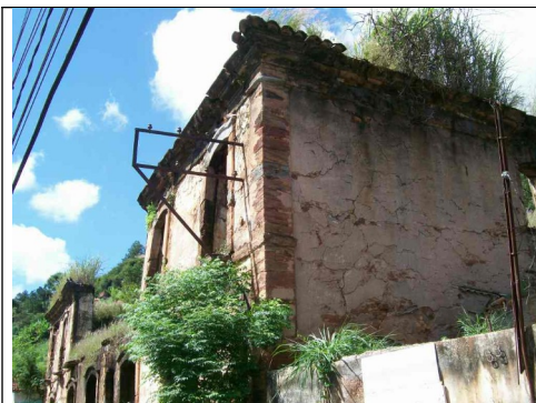
Figura 06 – Reboco trincado e vegetação sobre a alvenaria de pedra.
