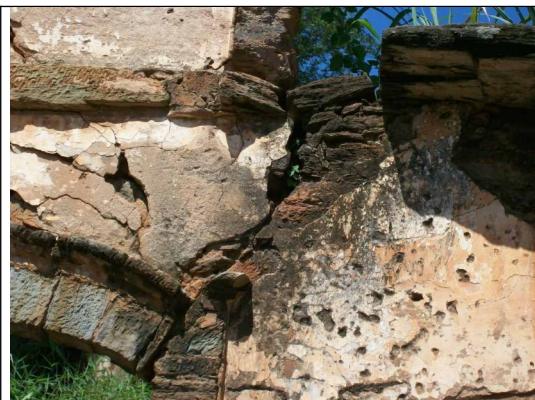
Figura 09 – Trincas junto às vergas dos vãos.
