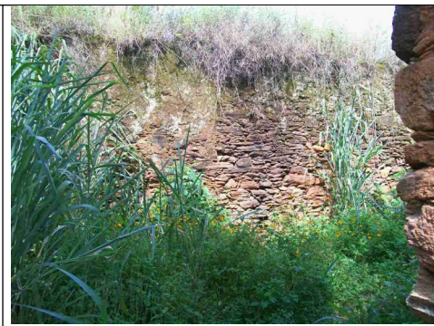
Figura 05 – mato no interior da edificação.
