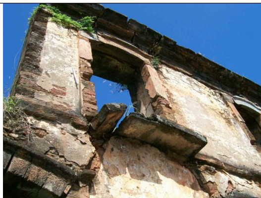
Figura 10 – Deslocamento das pedras de piso das sacadas.
