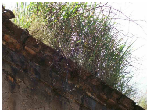
Figura 07 – Vegetação sobre a alvenaria de pedra.
