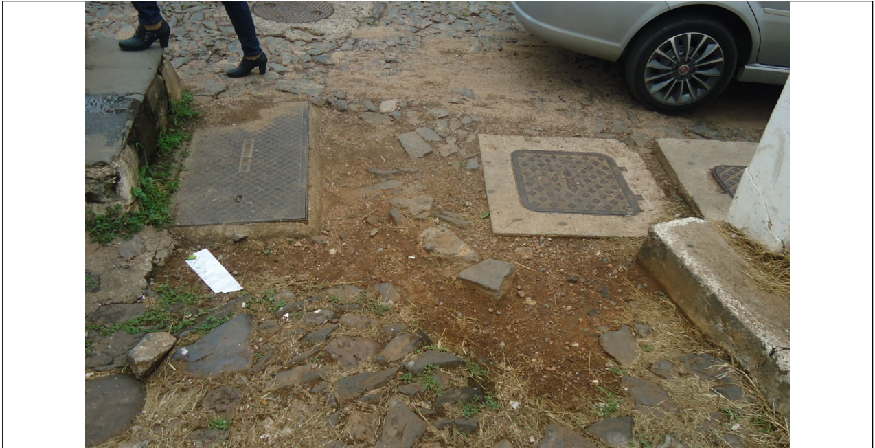
Figura 18 – Falhas na pavimentação da via.
