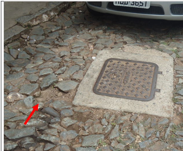
Figura 19 – Lacunas devido a ausência de pedras.
