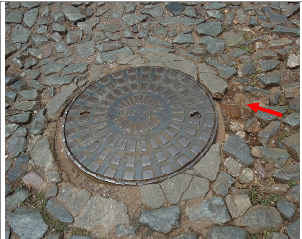
Figura 20 – Perda de trecho da moldura.
