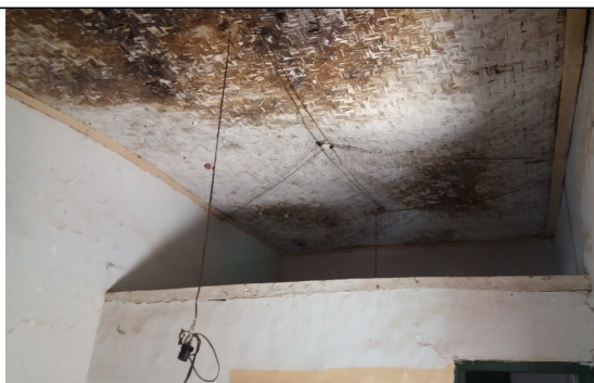
Figura 07 – Forro em esteira danificado.
