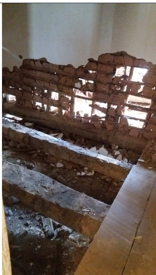
Figura 09 - Piso sem o tabuado, com os barrotes aparentes. Alvenaria de pau a pique com perda do enchimento.
