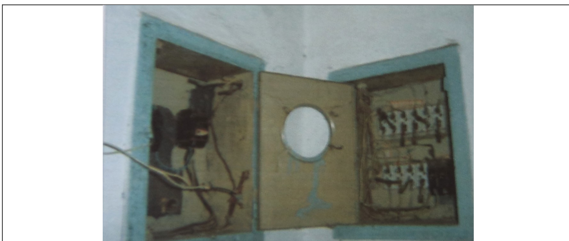
Figura 24 - Quadro de fiação da Igreja de Nossa Senhora do Rosário. Fonte: Biblioteca do IEPHA/Vistorias Técnicas (2006 – exercício 2007)
