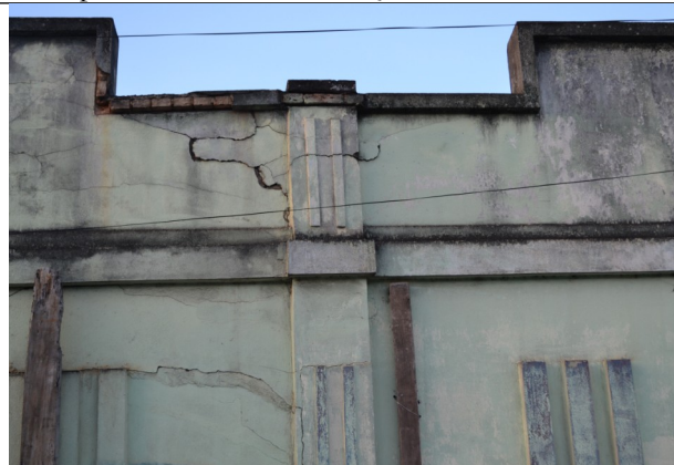
Figura 28 – Trecho escorado e com trincas nas alvenarias.
