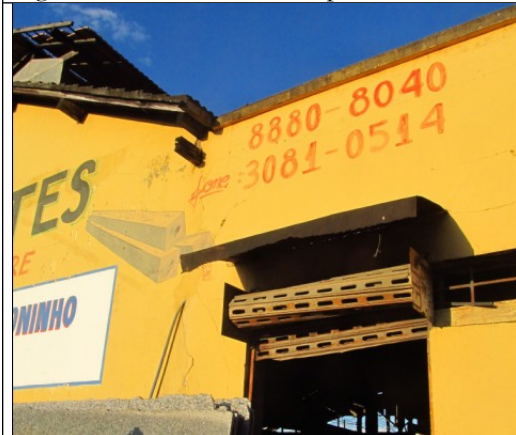
Figura 27 – Detalhe da descaracterização da fachada.
