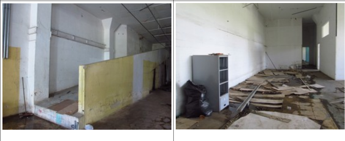
Figuras 71, 72, 73 e 74- Prédio do Frigorífico- parte interna. Fonte: Fotos da vistoria.
