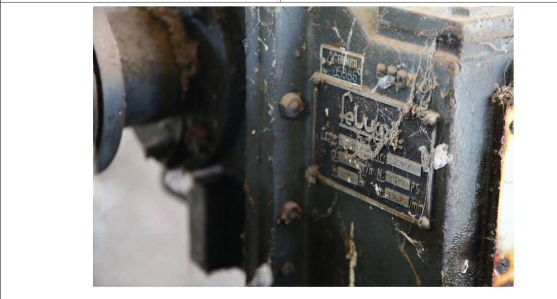
Figuras 123, 124, 125, 126 e 128 - Equipamentos existentes no interior do prédio da Caldeira. Fotos da vistoria
