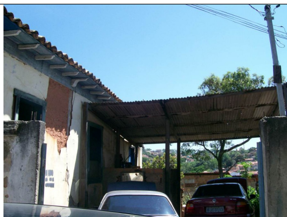
Figura 03 – Cobertura da oficina mecânica e desprendimento do reboco.
