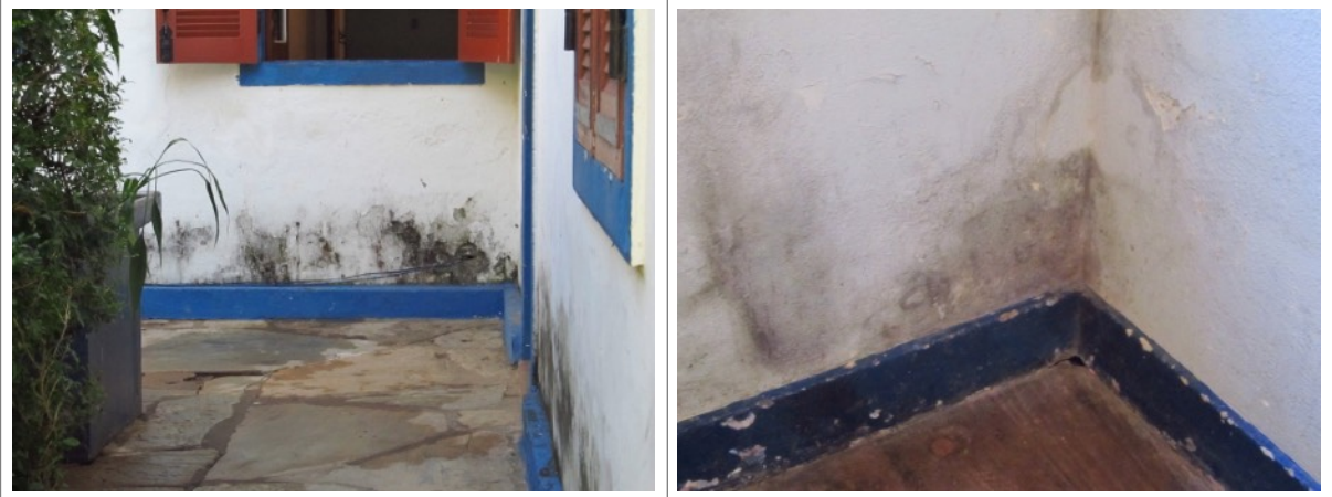
Figuras 25 e 26 – Manchas de umidade ascendente externas e internas nas paredes da Fazenda Boa Esperança em Santa Luzia. Fotografia da vistoria realizada em 18-06-2013.
