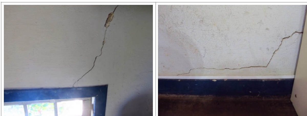
Figuras 23 e 24 – Trincas nas alvenarias da sede da Fazenda Boa Esperança em Santa Luzia. Fotografia da vistoria realizada em 18-06-2013.
