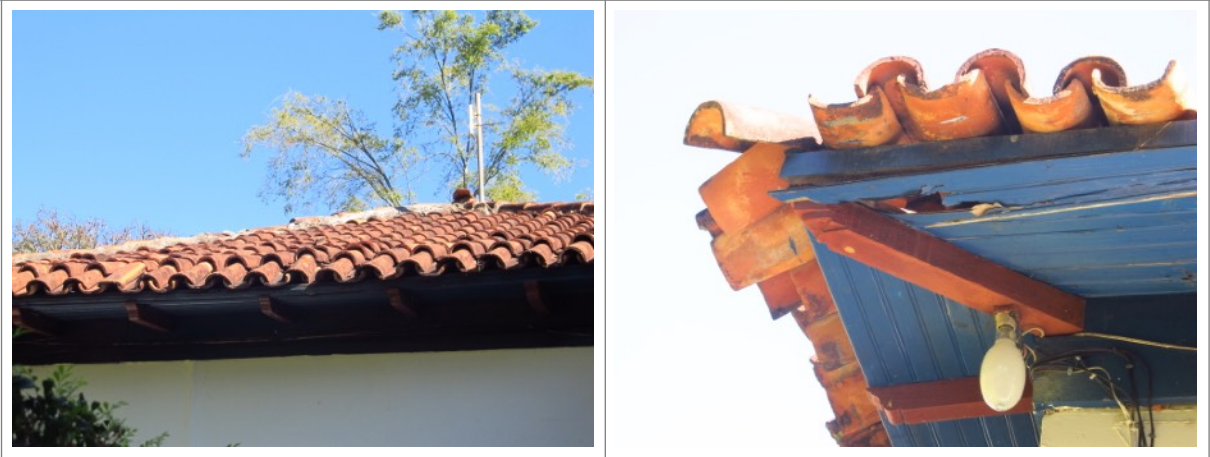
Figuras 33 e 34 – Situação da cobertura da sede da Fazenda Boa Esperança em Santa Luzia. Fotografia da vistoria realizada em 18-06-2013.
