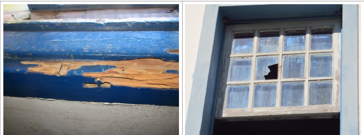
Figuras 27 e 28 – Esquadrias danificadas da sede da Fazenda Boa Esperança em Santa Luzia. Fotografia da vistoria realizada em 18-06-2013.
