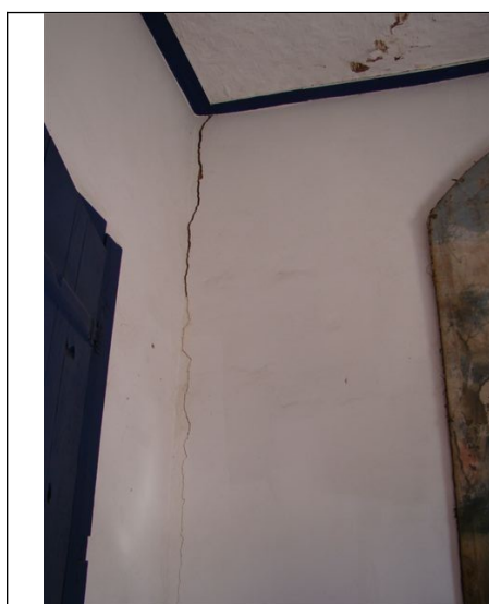
Figura 02 – Trincas na Casa de Cultura.
