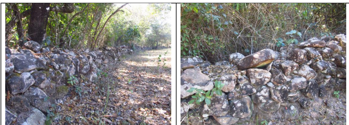
Fotos 9 e 10- Muro de Pedras. Na 2ª imagem, verifica-se a ocorrência de pedras soltas na estrutura arqueológica.
