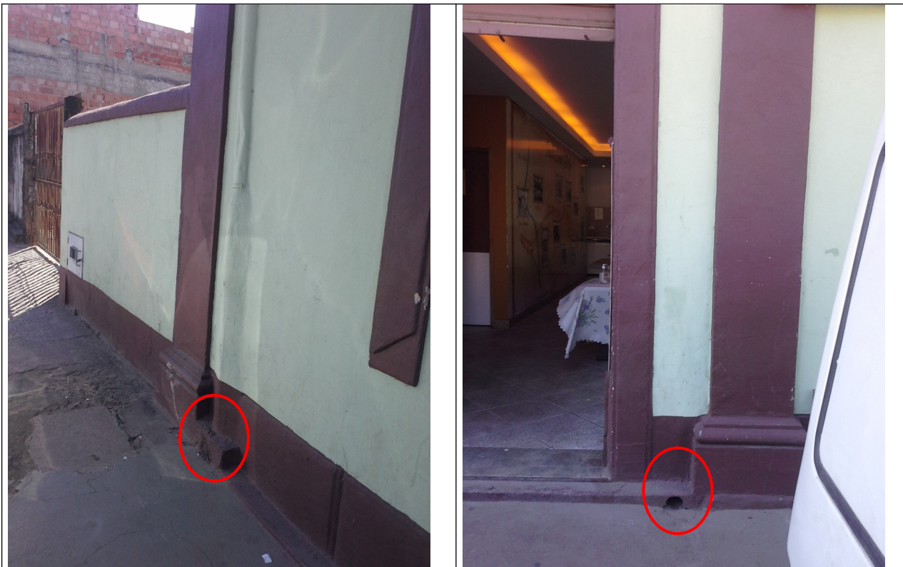
Figuras 06 e 07 – Tubulação de água pluvial lançando a água sobre passeios.
