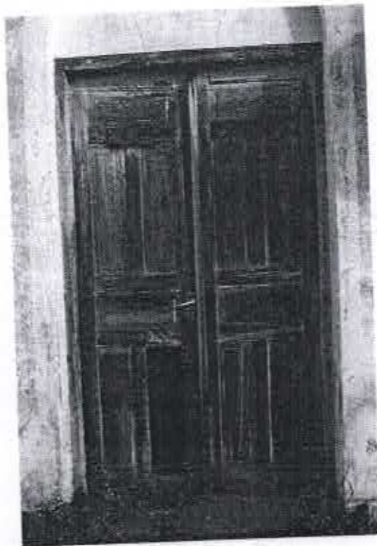
FOTO 27: Porta de acesso ao anexo direito da Igreja. Sua madeira já está ressecada e apresenta vários focos de cupins. Av. Genésio Franco de Moraes, s/nº - centro - Santa Vitória/MG Fev/2007
