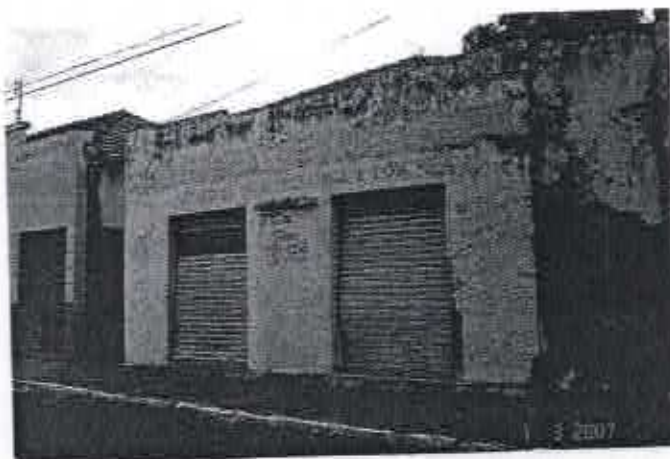
Foto 023: Edificação Eclética localizada na Av. São Paulo, entre as Ruas Golás e Matriz. Fonte: Bruna Quick – Fev/2007
