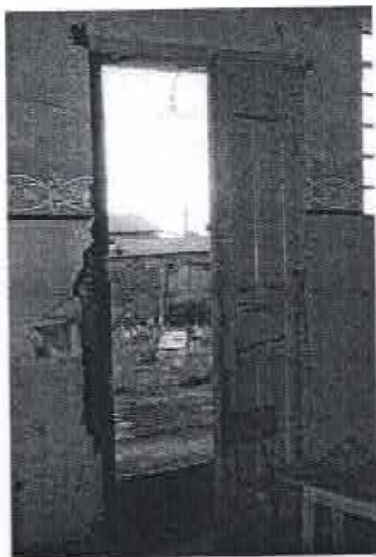
FOTO 18: Porta de acesso ao pátio lateral. Uma de suas folhas foi arrancada e a outra encontra-se muito deteriorada, devido à presença de cupins.
