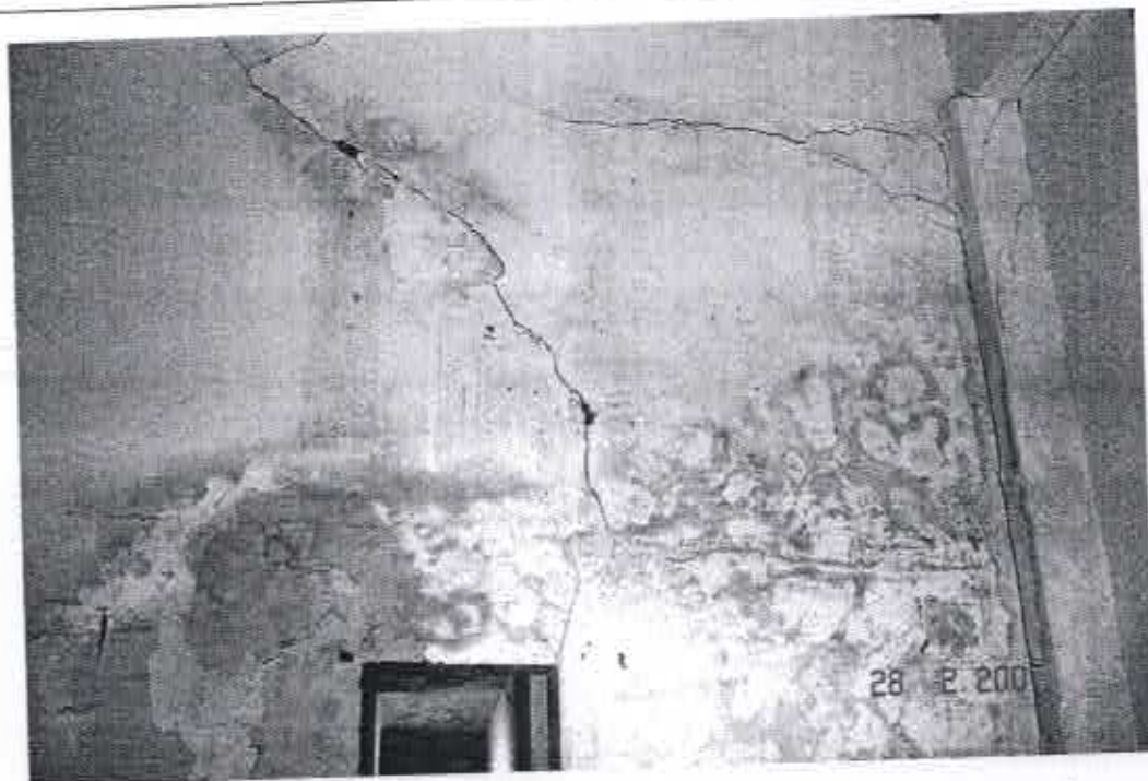
FOTO 24: Parede lateral do anexo esquerdo. Observa-se a presença de algumas trincas e grandes manchas de umidade, indicando graves infiltrações.
