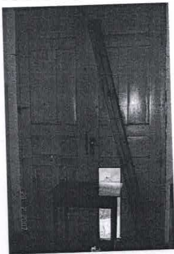
FOTO 11: Porta de acesso ao anexo direito da Igreja. Parte de sua almofada inferior foi retirada. Nota-se também a presença de insetos xilófagos em sua estrutura. Av. Genésio Franco de Moraes, s/nº - centro - Santa Vitória/MG Fev/2007
