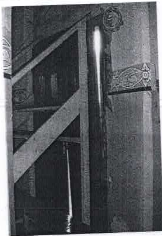
FOTO 28: Porta principal da Igreja. Uma de suas folhas encontra-se completamente solta e parte do marco foi arrancado. Av. Genésio Franco de Moraes, s/nº - centro - Santa Vitória/MG Fev/2007
