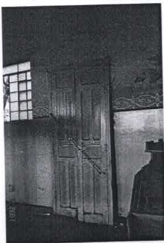
FOTO 15: Porta de acesso ao jardim lateral. A estrutura de madeira está toda comprometida devido ao ataque de cupins. Parte de suas ferragens foram arrancadas, prejudicando o fechamento do vão.
