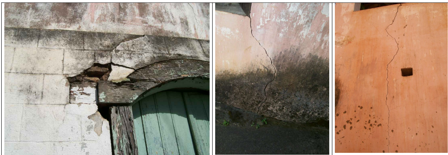
Figuras 11 a 13 – Trincas e descolamento do reboco
