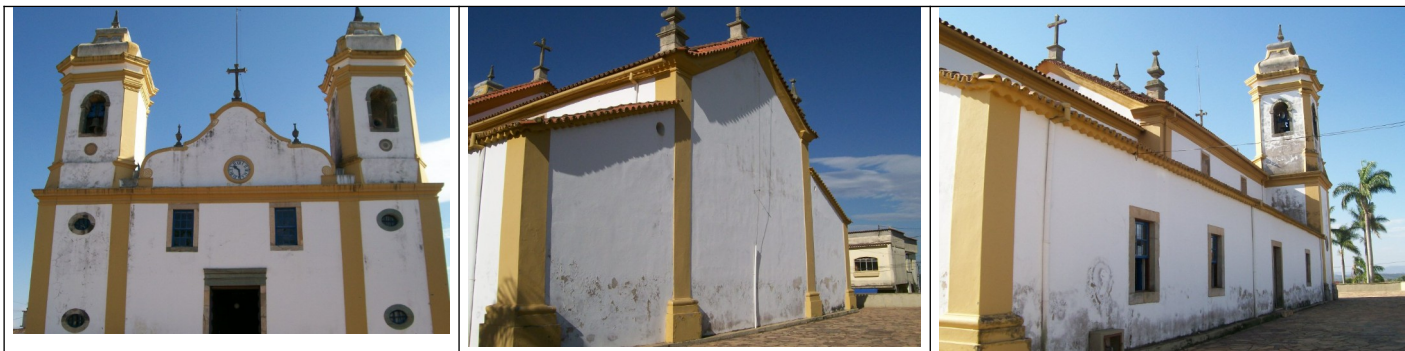
Figuras 13 a 15 – Fachadas da edificação onde se podem observar os problemas de umidade e patologias no reboco e pintura.
