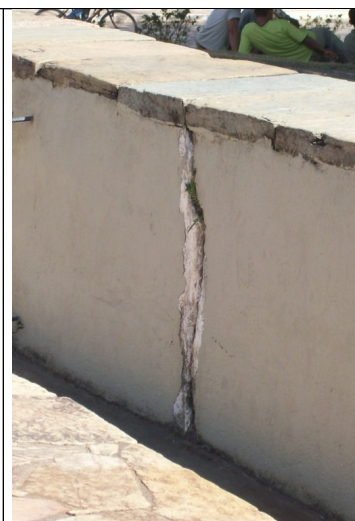
Figura 22 – Trinca no muro que circunda o adro.
