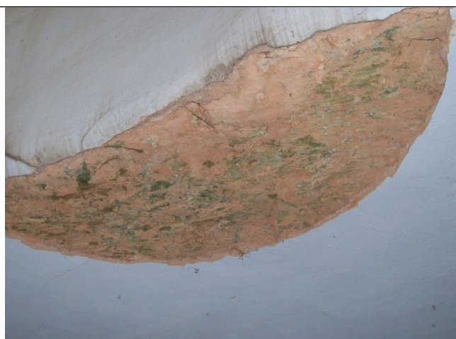
Figura 19 – Desprendimento do reboco da torre direita.
