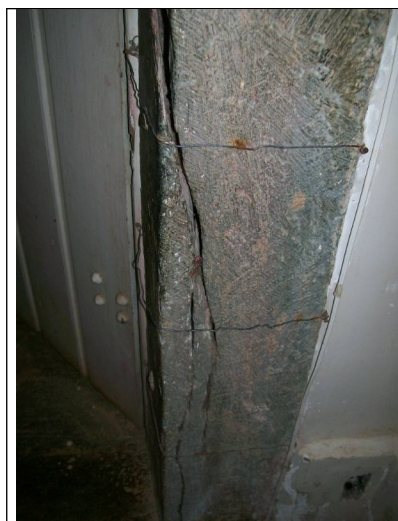
Figura 20 – Trinca no enquadramento de pedra.
