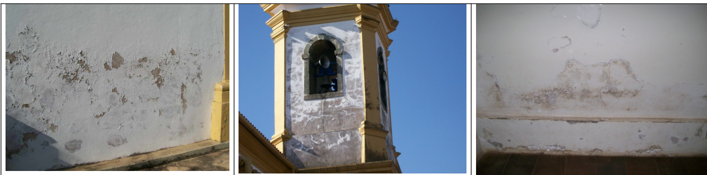
Figuras 15 a 17 - Problemas de umidade e patologias no reboco e pintura.
