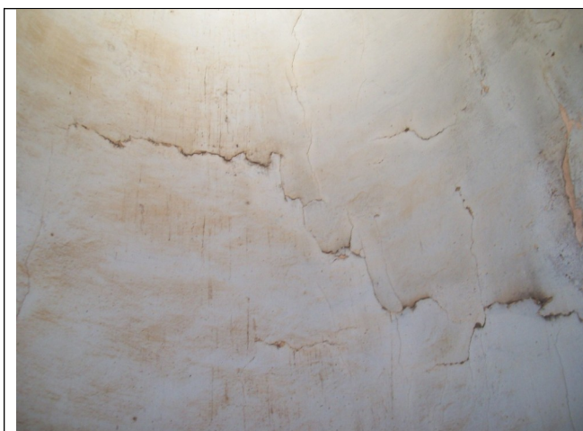
Figura 18 - Trincas na alvenaria da torre direita.
