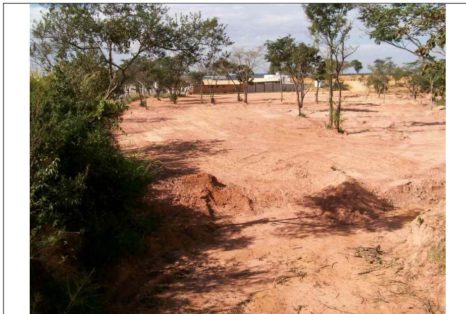
Figura 13 – Intervenção no terreno entre o loteamento em questão e o posto de gasolina localizado nas proximidades.
