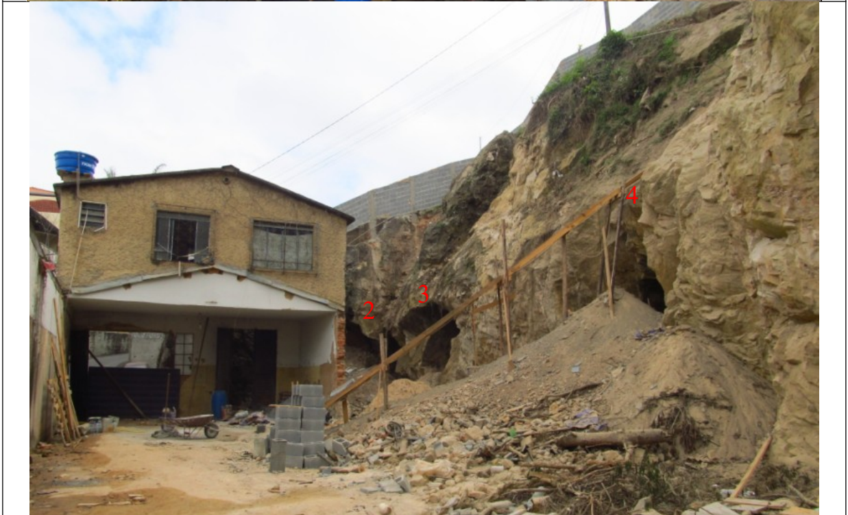
Figuras 13 e 14- Posição das betas, numeradas de 1 a 4, na Rua Aureliano Raposo, nº 09, Centro, São João Del Rei. Fotos da vistoria realizada em 22-07-2015.
