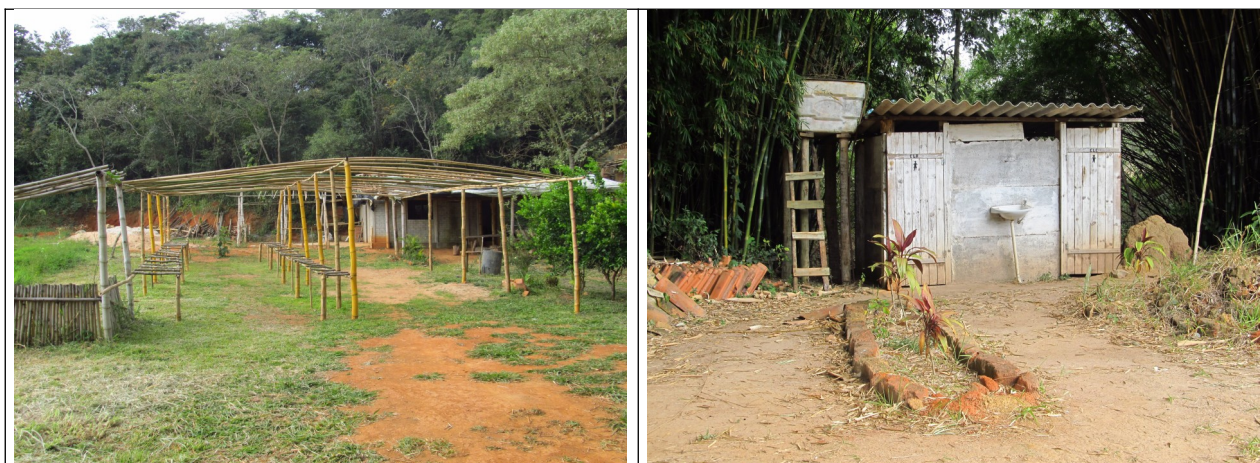
Figuras 34 e 35 – Outras intervenções na área das ruínas da primitiva Capela de Santo Antônio do Rio das Mortes Pequeno. Fotos da vistoria 22-7-2015.
