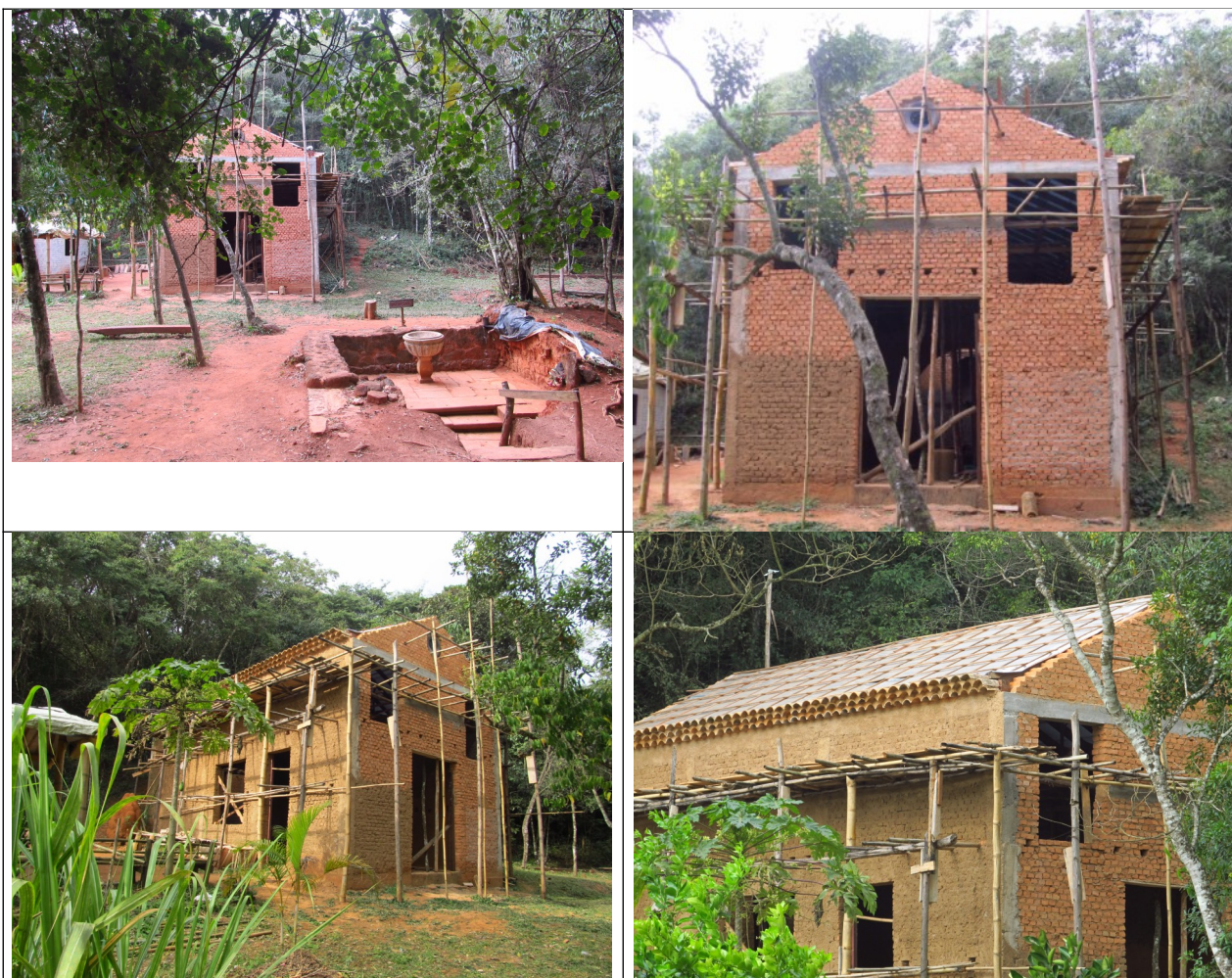
Figuras 30, 31, 32 e 33 – Edificação de uma nova capela na área das ruínas da primitiva Capela de Santo Antônio do Rio das Mortes Pequeno. Fotos da vistoria 22-7-2015.
