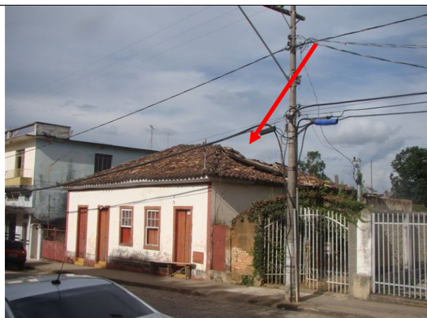
Figura 2 – Extensão da fachada do imóvel. Verifica-se na fotografia que a edificação perdeu parte de seu telhado. Fonte: Laudo nº 37/2013 Promotoria de Patrimônio Cultural.
