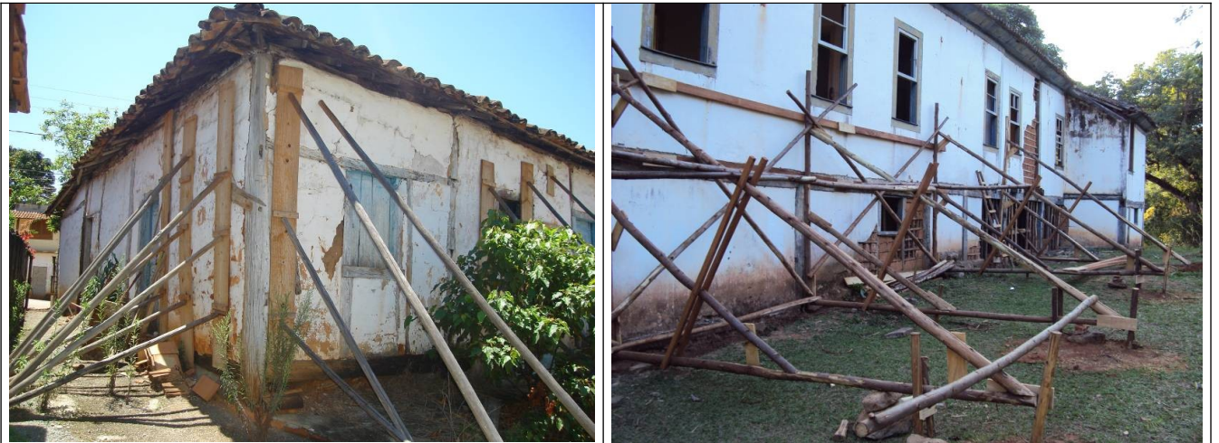
Figuras 04 e 05 – Imagens de escoramentos de fachadas. Fonte : acervo pessoal e do Escritório Técnico do Iphan em São João Del Rei
