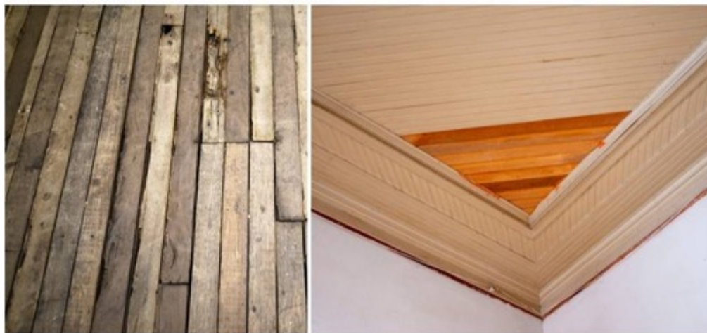
Figura 56: Piso e forro com madeira de substituição (cedrinho) da área de serviço no 1º piso do Palacete de José Caetano Borges, Uberaba, MG.
