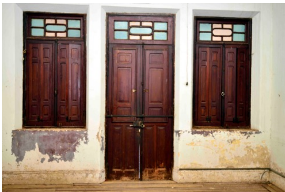
Figura 55: Outro exemplo de porta e janelas no 1º piso do Palacete de José Caetano Borges, Uberaba, MG.
