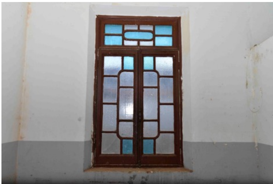
Figura 54: Exemplo de janela em madeira e vidro no 1º piso do Palacete de José Caetano Borges, Uberaba, MG.
