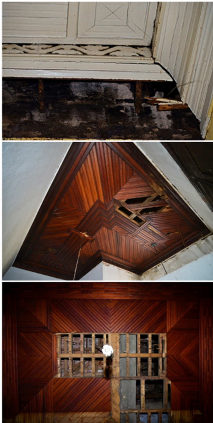
Figura 60: Exemplos forros deteriorados, encontrados no Palacete de José Caetano Borges, Uberaba, MG.
