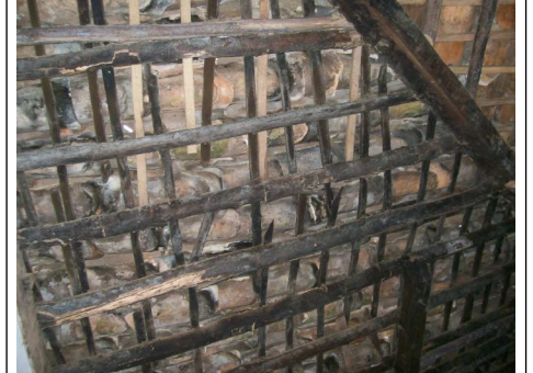
Figura 14 – Telhas quebradas e estrutura deteriorada.
