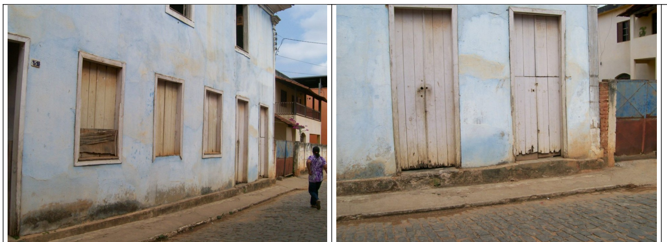
Figuras 27 e 28 – Esquadrias danificadas.
