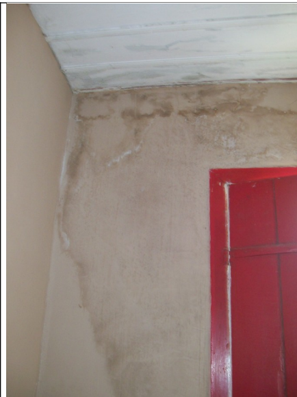
Figura 19 – Manchas de umidade.
