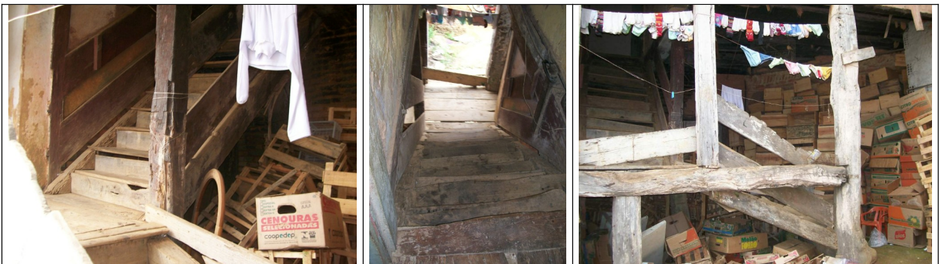
Figuras 24 e 25 – Escada em precário estado de conservação.
