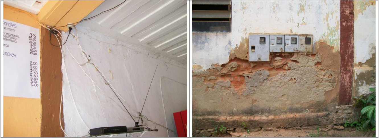
Figuras 21 e 22 – Instalações elétricas precárias.
