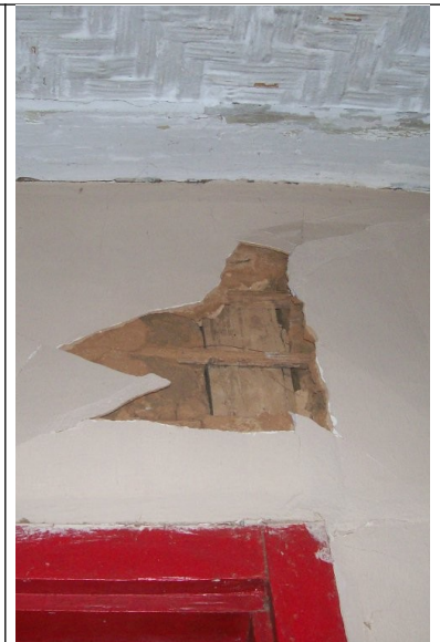
Figura 20 – Descolamento do reboco.
