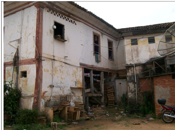
Figura 23 – Instalações elétricas e hidráulicas aparentes
