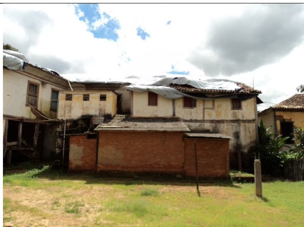
Figura 03 – Fundos da edificação com trecho da cobertura desprotegido.
