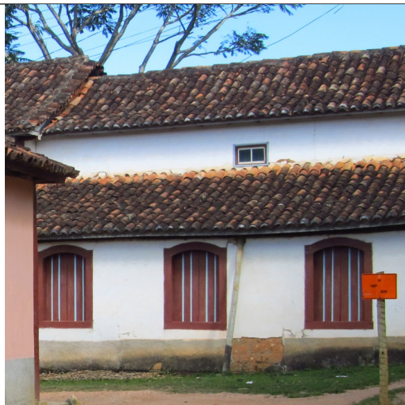
Figura 12 – Fachada lateral direita com escora na alvenaria e descolamento de reboco junto à base.
