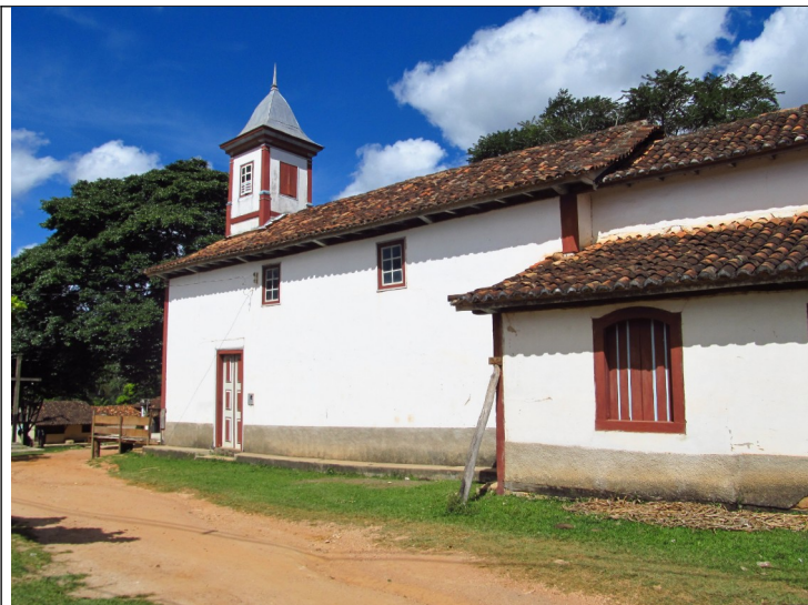
Figura 11 – Fachada lateral direita com escora no cunhal.
