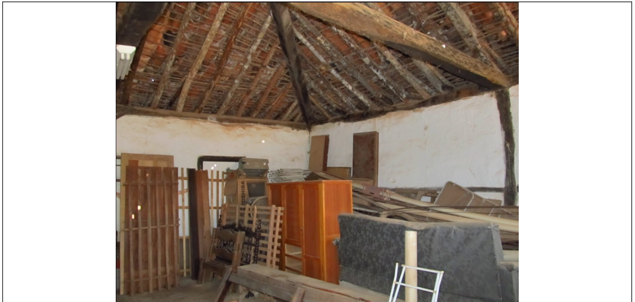
Figura 11 – Material armazenado no interior da edificação. Foto da vistoria.
