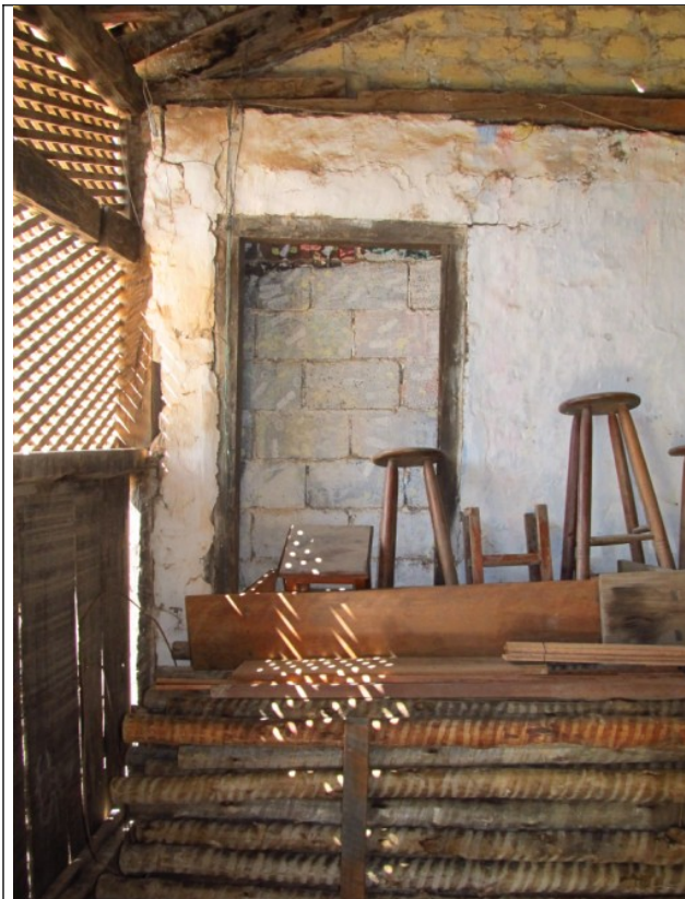
Figura 09 – Material armazenado no interior da edificação e vedação da porta de ligação entre o rancho e a edificação adjacente.
