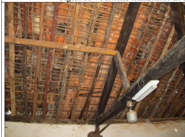
Figura 12 – Lâmpião a gás e instalações elétricas precárias.
