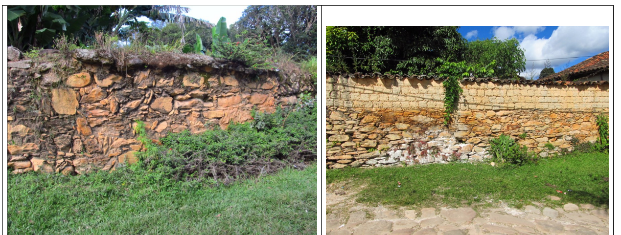
Figuras 23 e 24- Muros construídos em pedras no Distrito de São Gonçalo do Rio das Pedras. Fotos da vistoria.
