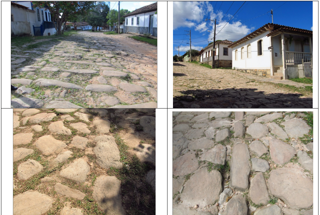
Figuras 19, 20, 21 e 22- Imagens do calçamento em São Gonçalo do Rio das Pedras. Fotos da vistoria.
