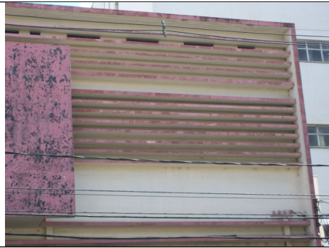
Figura 06 – Frisos horizontais e plano revestido por pastilhas, com pintura apresentado descolamento.
