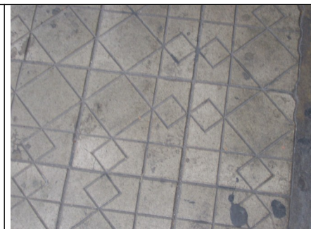
Figura 15 – Piso de ladrilhos hidráulicos da calçada.
