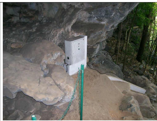
Figura 38 – Quadro de distribuição de energia na entrada da gruta.
