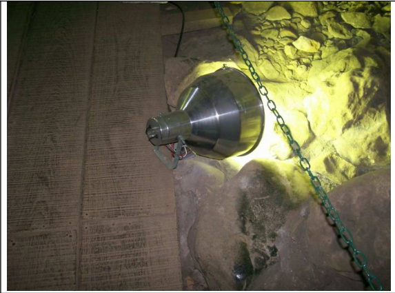
Figura 44 – Luminária instalada no deck de madeira.
