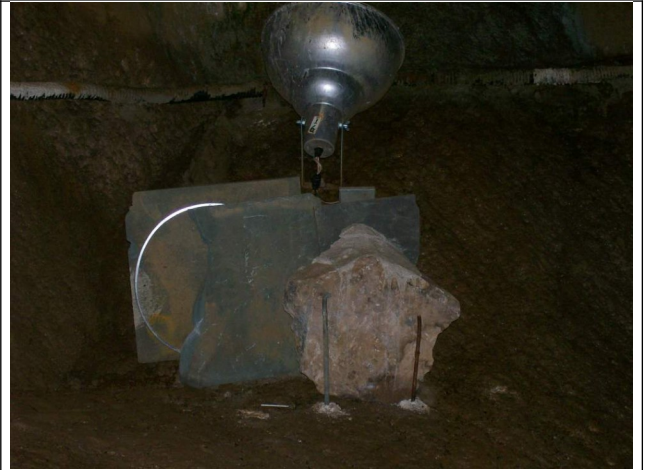
Figura 29 – Luminária aparente – descaracterização.
