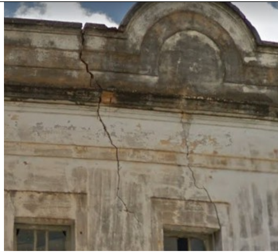
Figura 06 – Trinca frontal em setembro de 2013.
