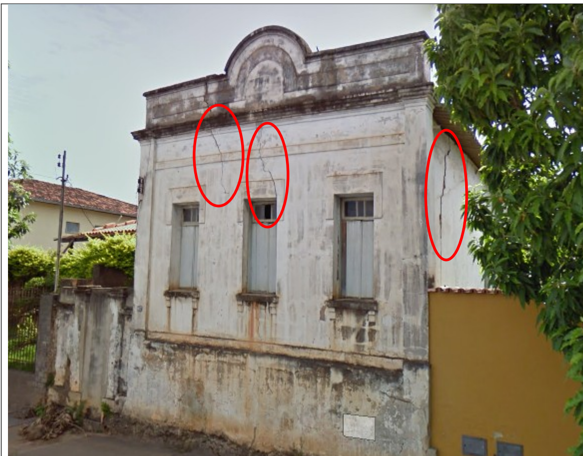
Figura 02 – Fachada do imóvel em novembro de 2009. Em destaque, trincas existentes.
