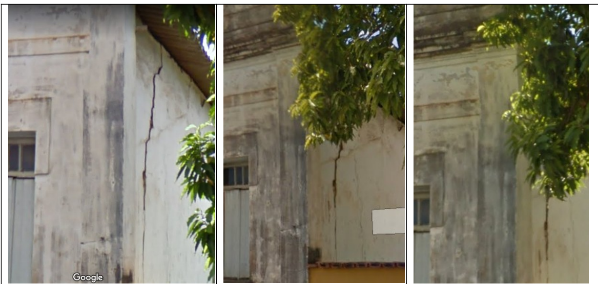
Figura 07, 08 e 09 – Trinca lateral em novembro de 2009, setembro de 2013 e fevereiro de 2014.
