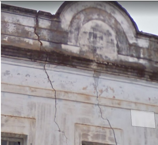
Figura 05 – Trinca frontal em novembro 2009.
