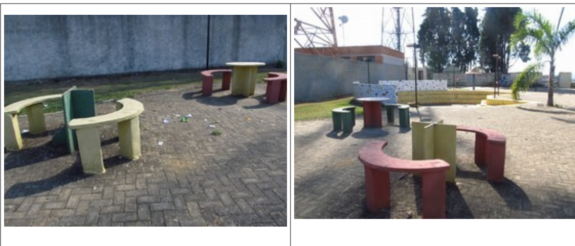
Figuras 16 e 17- Mobiliário urbano danificado no entorno do Monumento Cristo Redentor. Fotos da vistoria.
