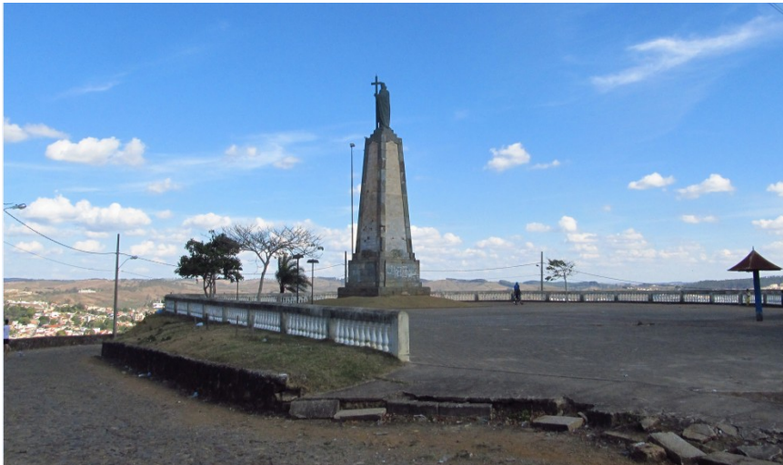
Figura 13- Danos na pavimentação no entorno do Monumento Cristo Redentor. Fotos da vistoria.
