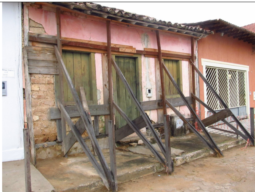
Figura 08 – Imagem de escoramento de fachadas. Fonte: Setor Técnico Promotória Estadual de Defesa do patrimônio Cultural e Turístico de MG.
