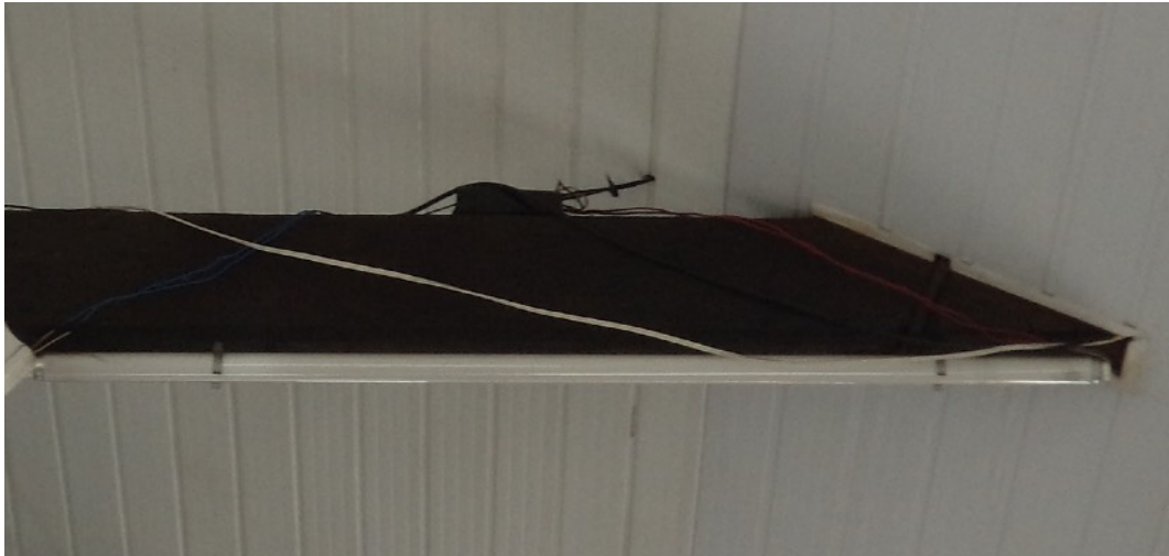
Figura 50 – Fiação exposta junto à madeira. Fonte: Promotoria de Patrimônio Cultural – vistoria 26 de agosto.
