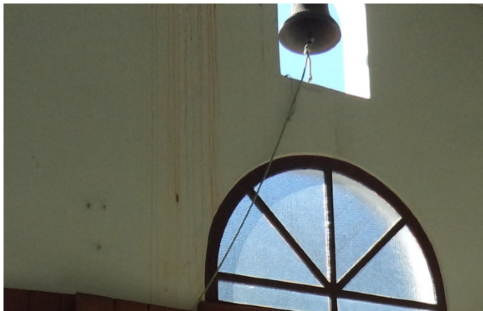
Figura 51 – Manchas de umidade na alvenaria. Fonte: Promotoria de Patrimônio Cultural – vistoria 26 de agosto.
