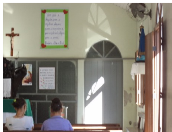
Figura 40 – Desprendimento de tinta na parede imediatamente posterior ao altar. Fonte: Promotoria de Patrimônio Cultural – vistoria 26 de agosto.
