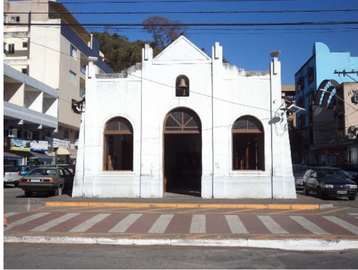
Figura 15 – Fachada principal do templo. Fonte: Promotoria de Patrimônio Cultural – vistoria 26 de agosto.
