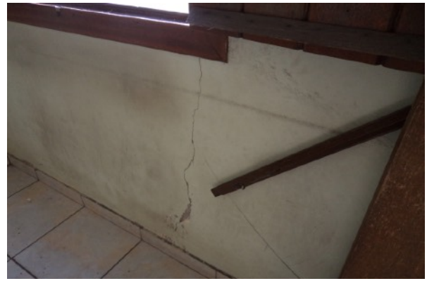
Figura 37 – Rachadura e desprendimento de reboco. Parede necessitando de pintura. Face interna da fachada. Fonte: Promotoria de Patrimônio Cultural – vistoria 26 de agosto.
