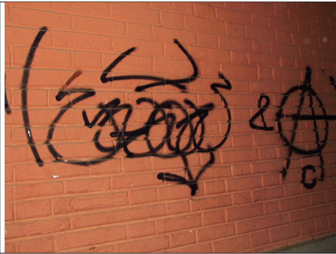
Figura 13 – Pichações. Fonte: fotos da vistoria.
