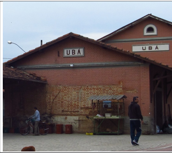
Figura 14 –Alvenaria sem acabamento após demolição de anexo. Fonte: fotos da vistoria.
