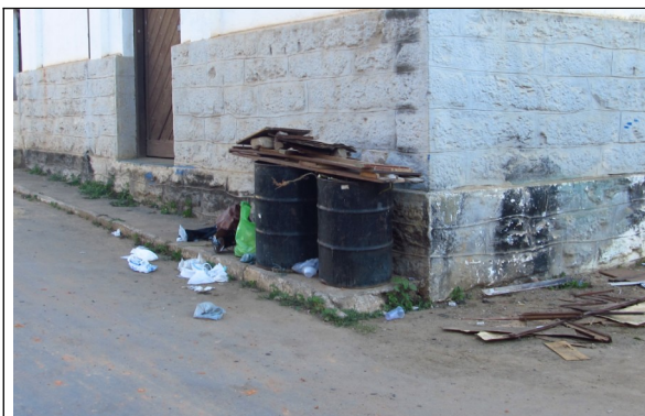
Figura 16 – Lixo e sujeira no entorno do prédio. Fonte: fotos da vistoria.
