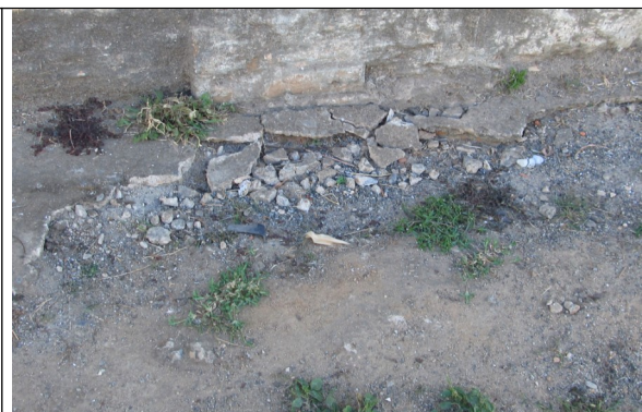
Figura 17 – Danos na calçada. Fonte: fotos da vistoria.
