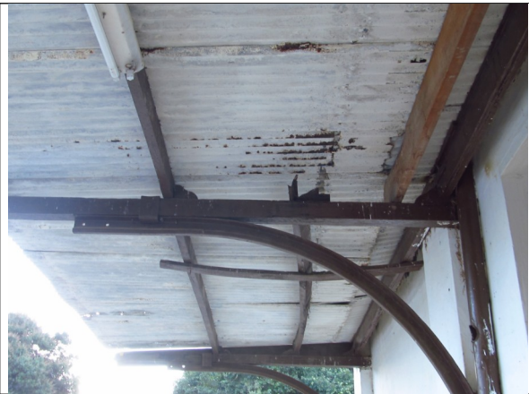
Figura 12 – Danos na estrutura e oxidação das telhas da plataforma. Fonte: fotos da vistoria.
