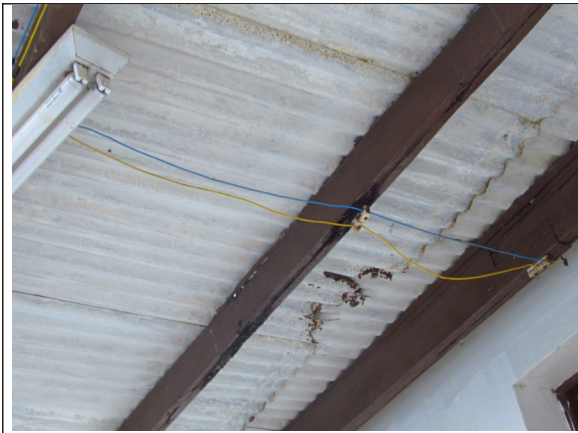
Figura 11 – Fiação exposta e luminária que não se harmoniza com o estilo da edificação. Fonte: fotos da vistoria.
