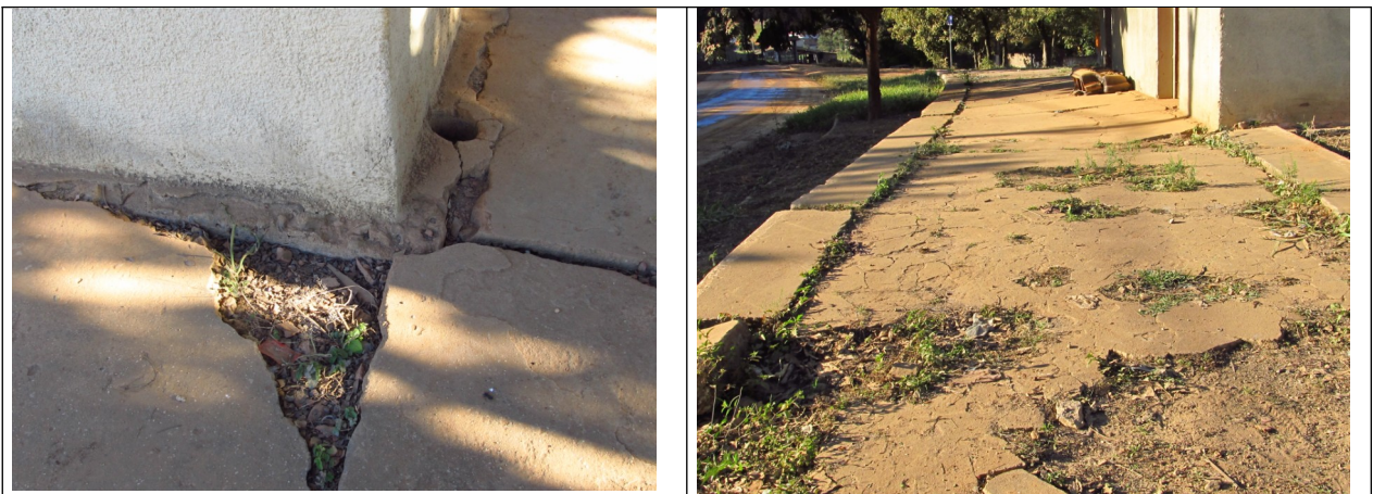
Figuras 26 e 27 - Danos na calçada.
