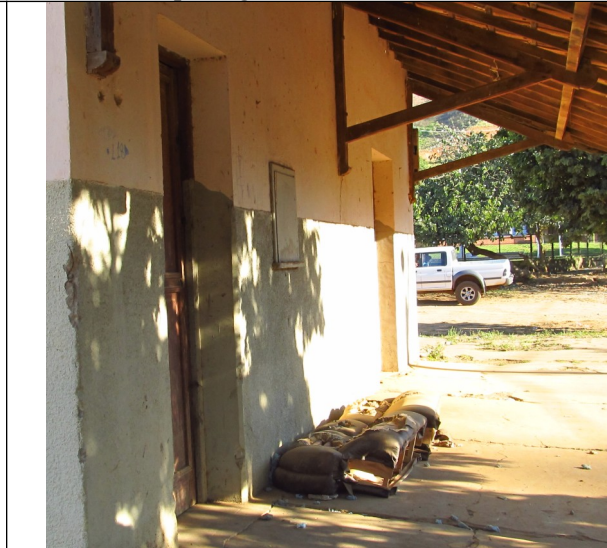
Figura 18 – Sujeira na plataforma e danos na pintura do prédio da estação de passageiros.
