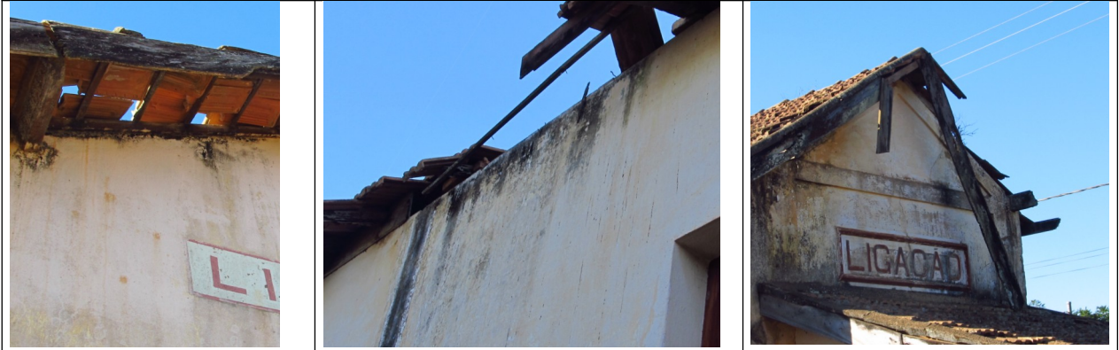
Figuras 21, 22 e 23 – Danos nas coberturas da estação de passageiros e depósito.
