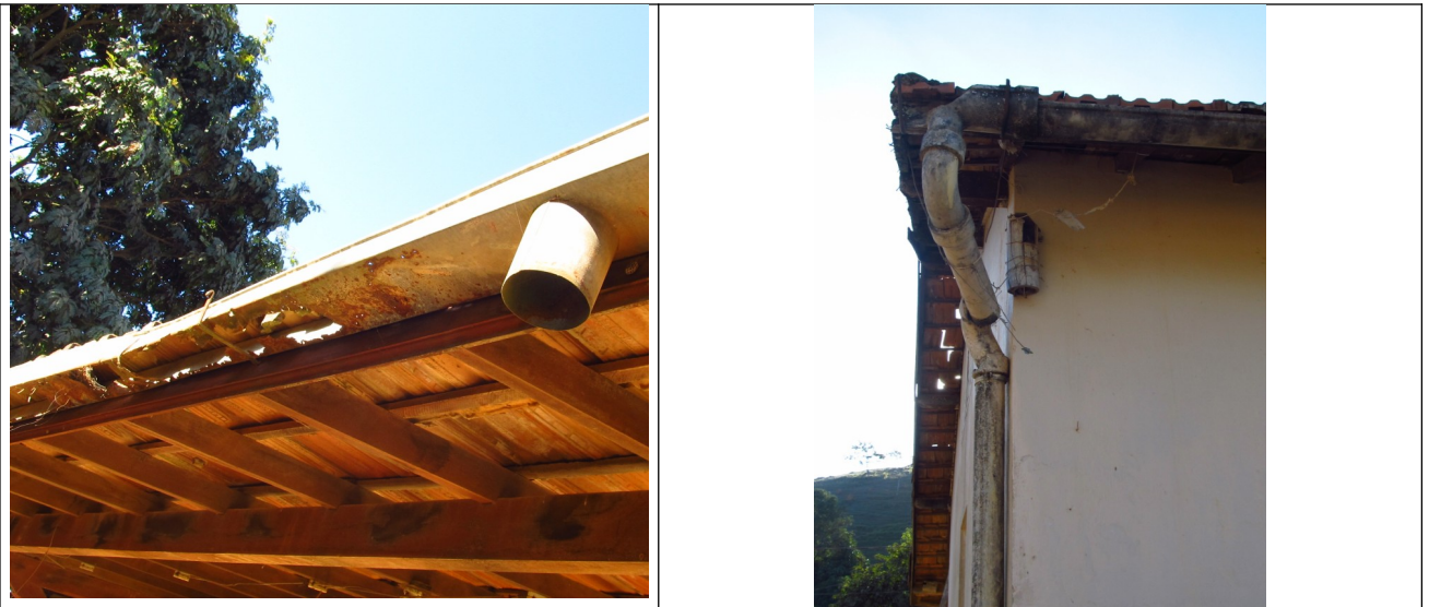
Figuras 24 e 25 – Calhas e condutores soltos e oxidados, favorecendo a presença de umidade nas alvenarias.
