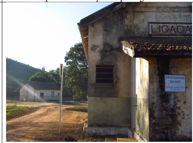
Figura 20 – Marchas de umidade nas alvenarias do depósito.
