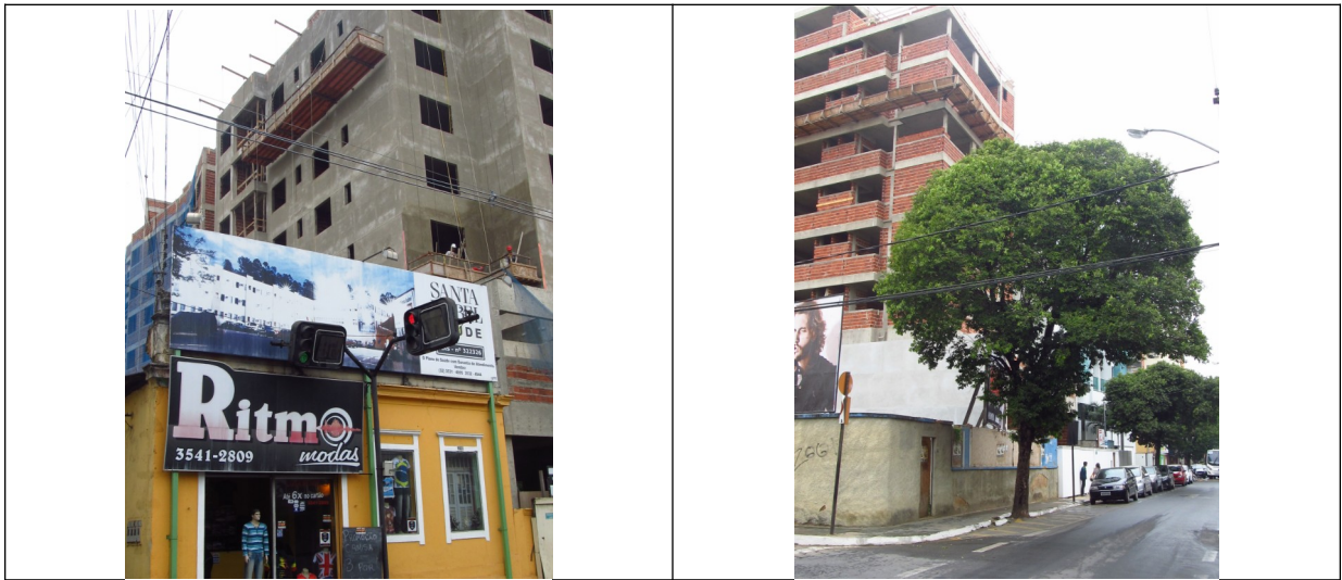
Figuras 19 e 20- Prédios em construção na Av. Governador Valadares e na Av. Raul Soares, respectivamente. Fotos da vistoria.
