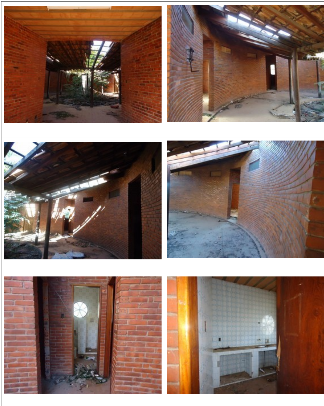
Figuras 7, 8, 9, 10, 11 e 12- Fotos internas da “Casa Redonda” ainda com parte da cobertura. Fonte: Documentação encaminhada pelo Setor Municipal responsável pelo Patrimônio Cultural.
