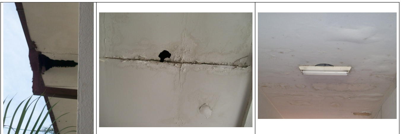
Figuras 19 a 21 – Marcas de infiltração de água nos beirais e forros.
