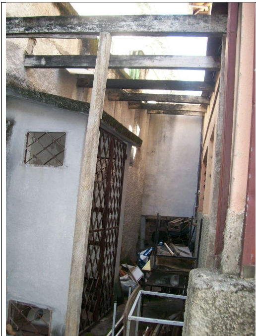
Figura 12 – Acúmulo de entulho nos fundos do terreno.
