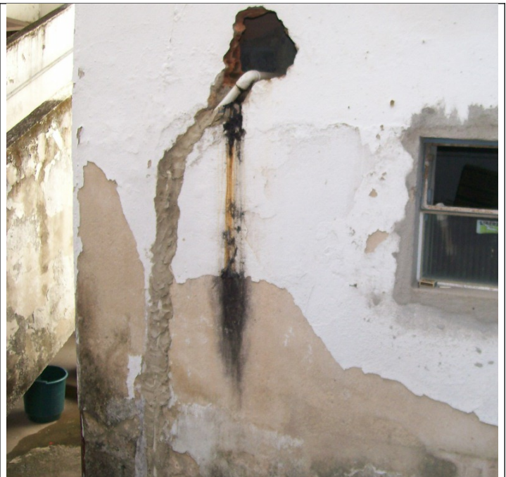
Figura 13 – Tubulação exposta, descolamento de reboco e pintura.
