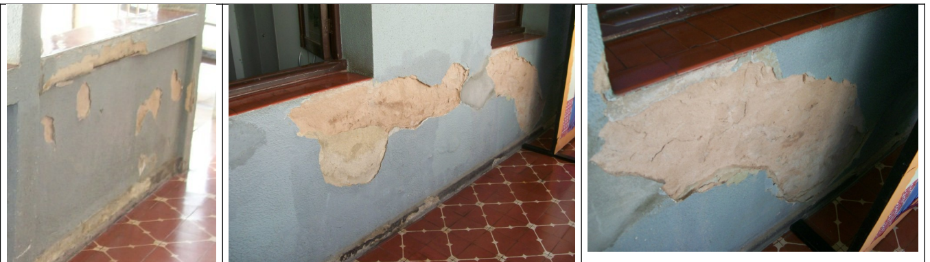
Figuras 16 a 18 – Descolamento de reboco.
