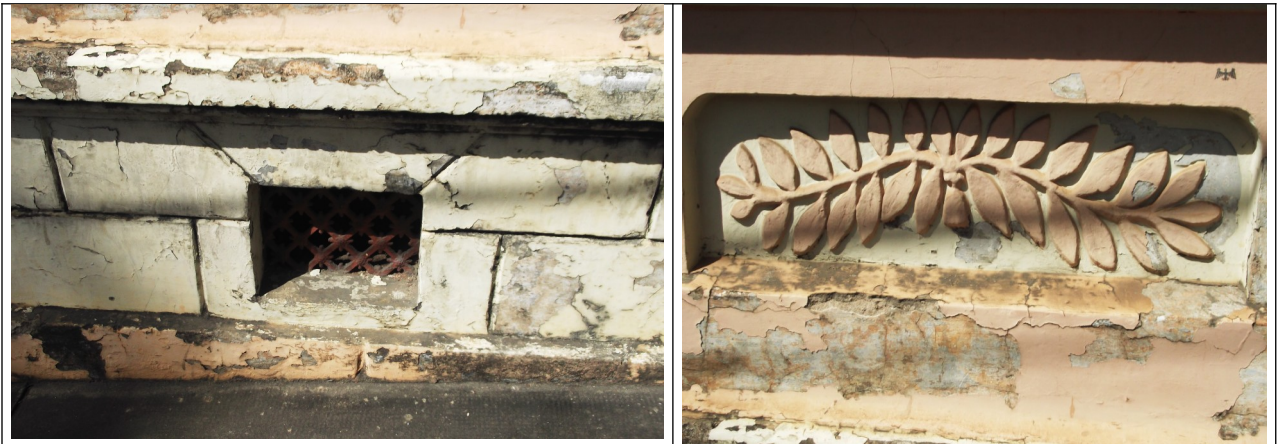
Figuras 14 e 15 – Manchas de umidade, trincas e desgaste da pintura.
