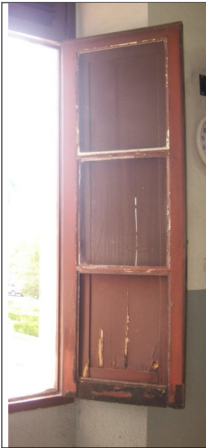
Figura 22 – Desgaste das esquadrias.
