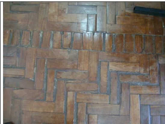
Figura 06 – Piso de tacos de madeira com partes preenchidas com massa.
