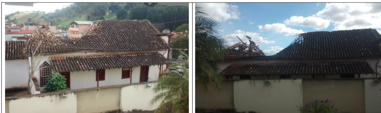
Figuras 08 e 09 – Vista da cobertura da edificação, em processo de arruinamento. Fonte: Procedimento de Apoio, junho de 2017.
