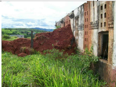
Figura 09 – Terra acumulada junto à alvenaria
